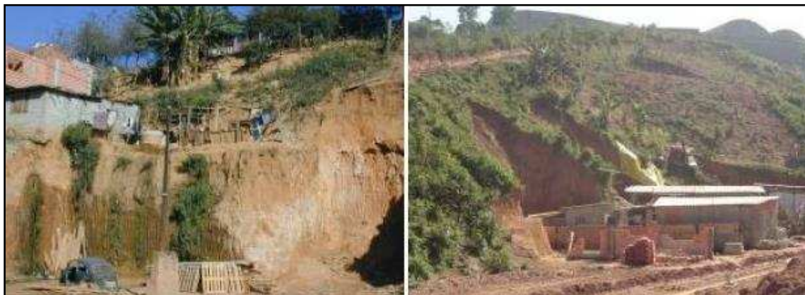
Figura 6 - Declividade e altura excessivas de corte. Fonte: IPT (1991).
