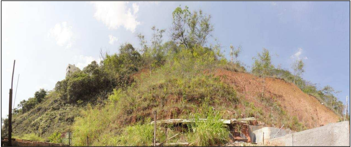
Figura 57 - Talude instável na área 1.
