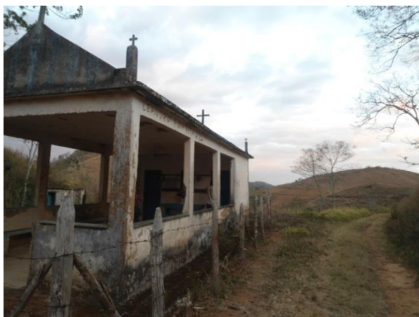
Figura 10. Capela no Alto da Serra, assim como outras estruturas da Fazenda estão se deteriorando com o tempo e falta de manutenção.
