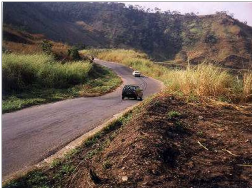
Figura 3.3 – Vista parcial de depreciação de trecho da rodovia BR-120, como resultado de erosão (Serra de São Geraldo, Coimbra, MG).
