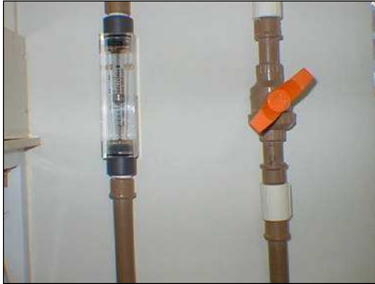
Figura 4.9 – Detalhe do medidor de vazão (Rotâmetro) e do registro de controle.
