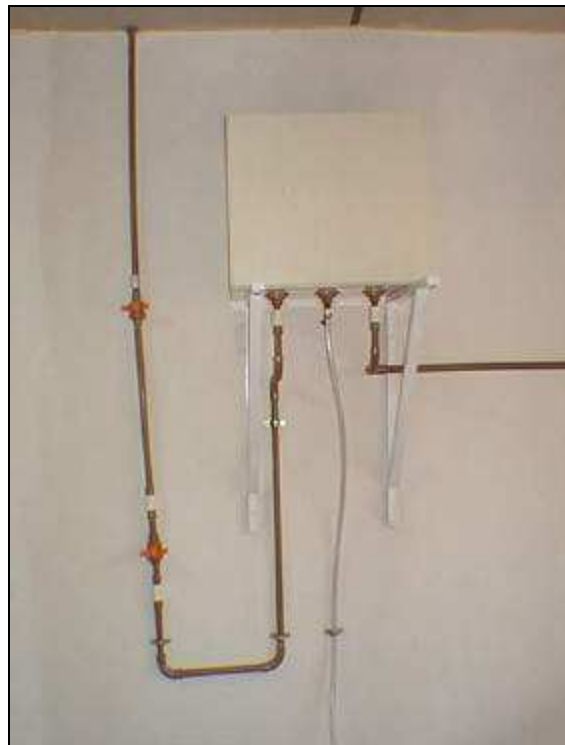
Figura 4.10 – Reservatório de água para regularizar a vazão de entrada no sistema. Mais a esquerda vêem-se dois registros, o superior é o registro geral e o inferior é o registro controlador da vazão de entrada.
