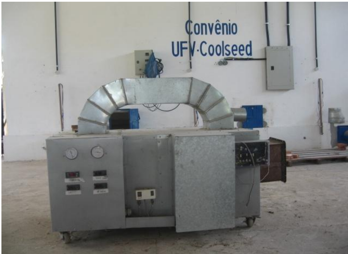
Figura 4- Unidade de tratamento de ar (UTA)
