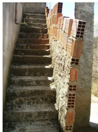
Figura 6.31: Construção de escadas externas para dar acesso à cobertura de ambientes acrescidos Fonte: Acervo da autora.
