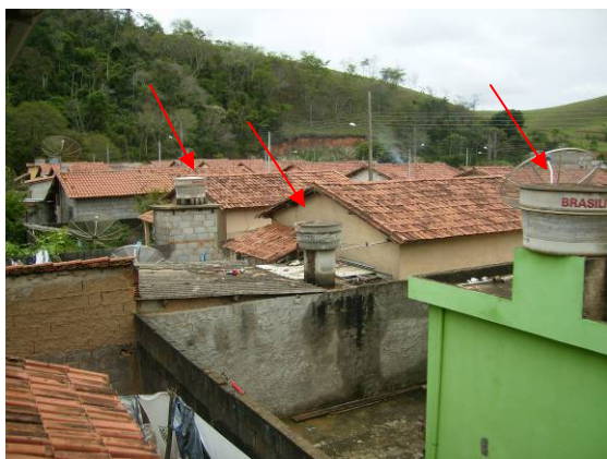
Figura 6.28: Alteração da localização da caixa d'água para área externa à residência Fonte: Acervo da autora.
