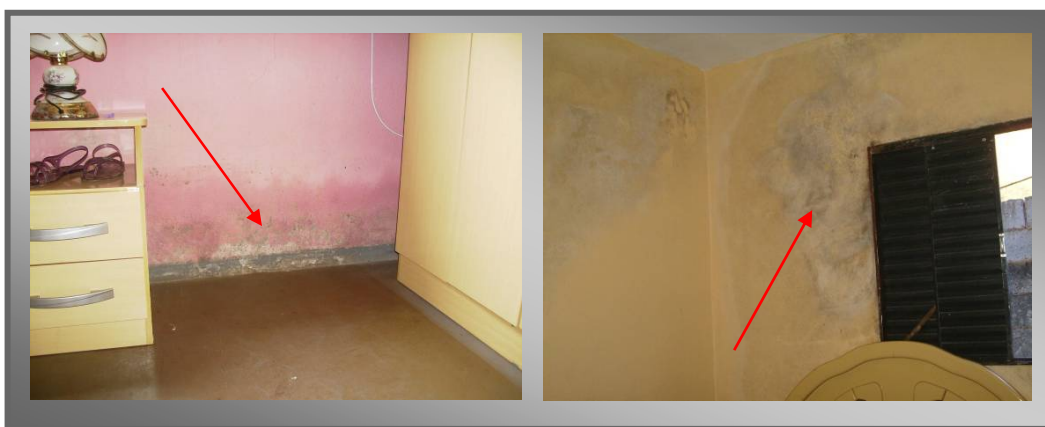
Figura 6.8: Umidade proveniente do solo por deficiência quanto a impermeabilização (esquerda), e de infiltração da laje sem cobertura ou sem sistema de impermeabilização (direita)
