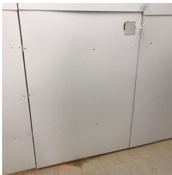
Figura 11 - Identificação da umidade na parede de PCM Macroencapsulados
