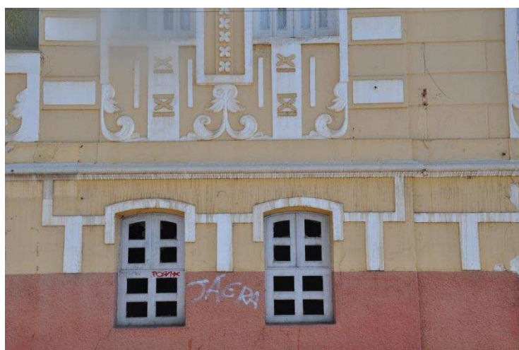
Figura 13 - Casa antiga pichada 83
