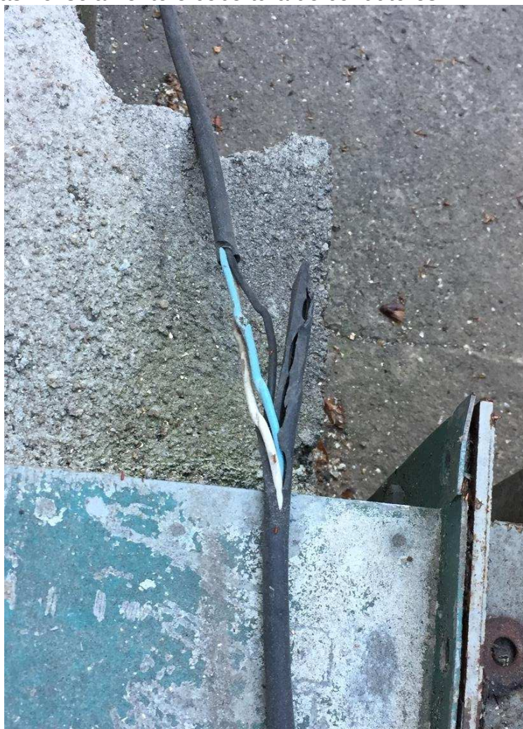
Figura 3 – Injúrias no isolamento e cobertura de condutores
