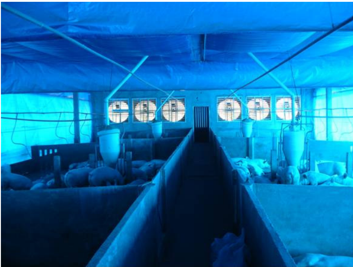
Figura 13. Vista do interior do galpão equipado com o sistema de ventilação tipo túnel.
