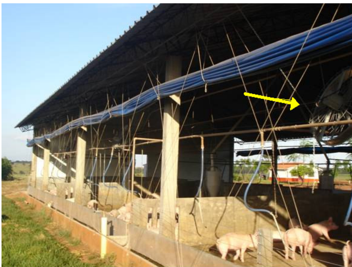
Figura 11. Vista do interior do galpão equipado com o sistema de ventilação tipo lateral.
