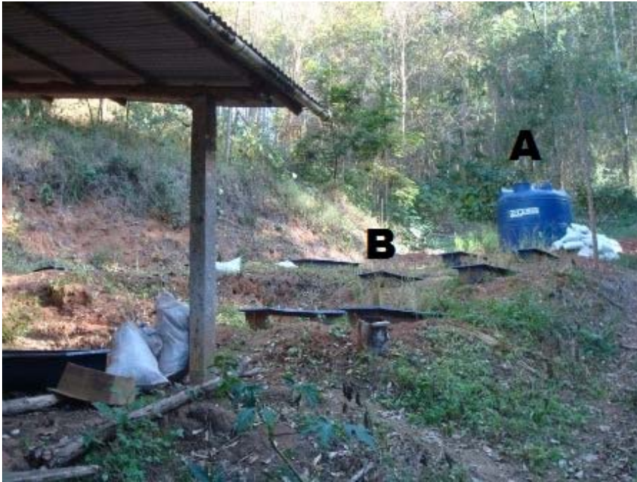
Figura 4.4: Sistema de tratamento e pós-tratamento: A- Reator Anaeróbio Híbrido; B- Sistemas Alagados Construídos.
