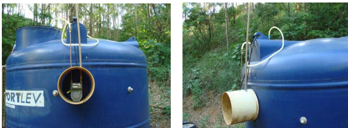
Figura 4.10: Vistas central e lateral do medidor de biogás utilizado.
