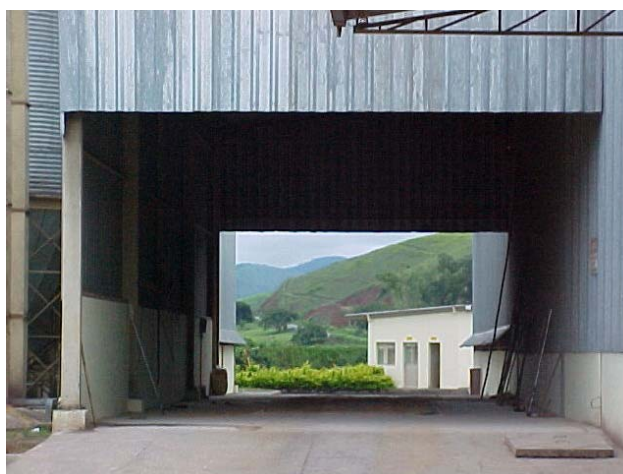
Figura 8. Vista parcial da moega para recepção dos grãos.
