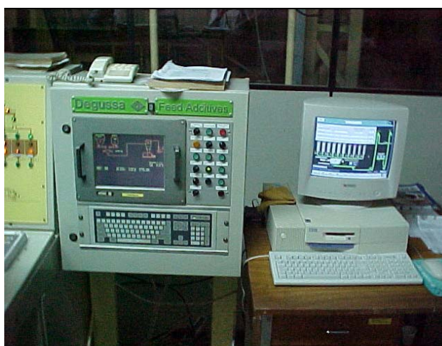
Figura 12. Sistema de controle automático de pesagem e dosagem de ingredientes.
