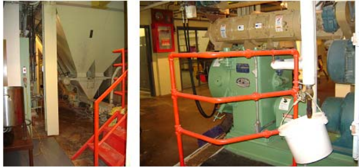
Figura 3. Vista parcial da área interna da fábrica de ração, Kansas, EUA.
