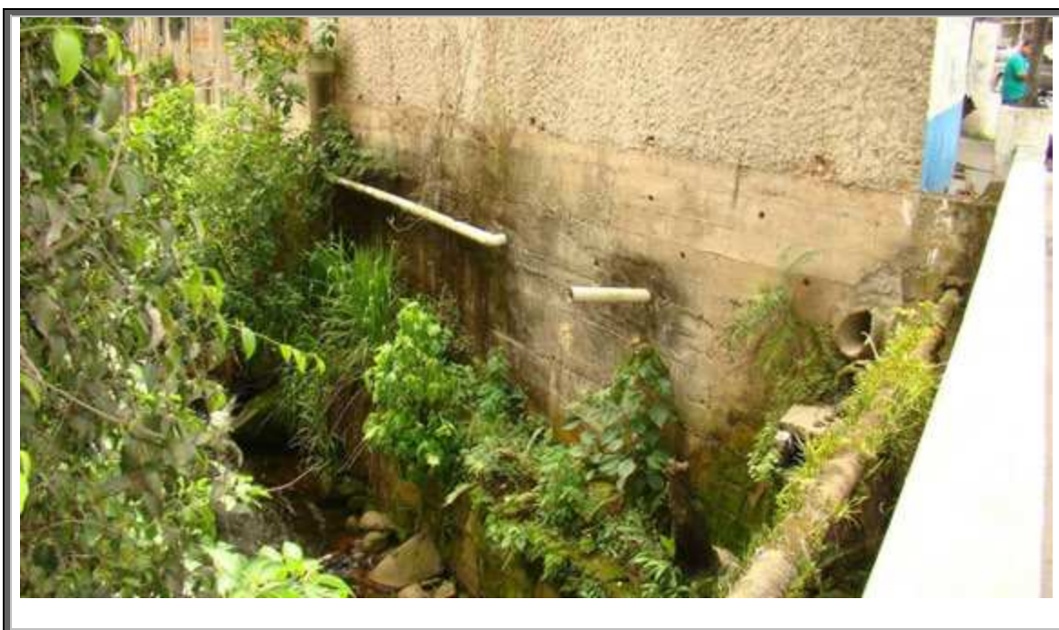
Figura 7.32 – Remoção da mata ciliar, ocupação do leito maior do rio Cônego e lançamento de águas residuárias, trecho no bairro Cônego.
