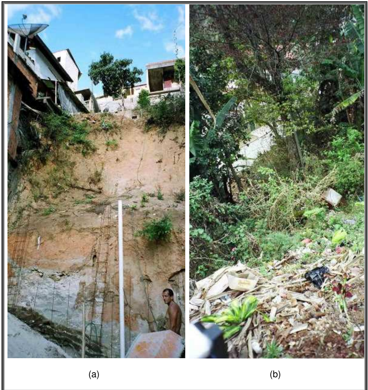
Figura 5.28 – Corte mal executado (vertical) em talude instável (a) e lançamento de lixo e detritos em talude (b), bairro Vilage (Fonte: Defesa Civil, 2007).
