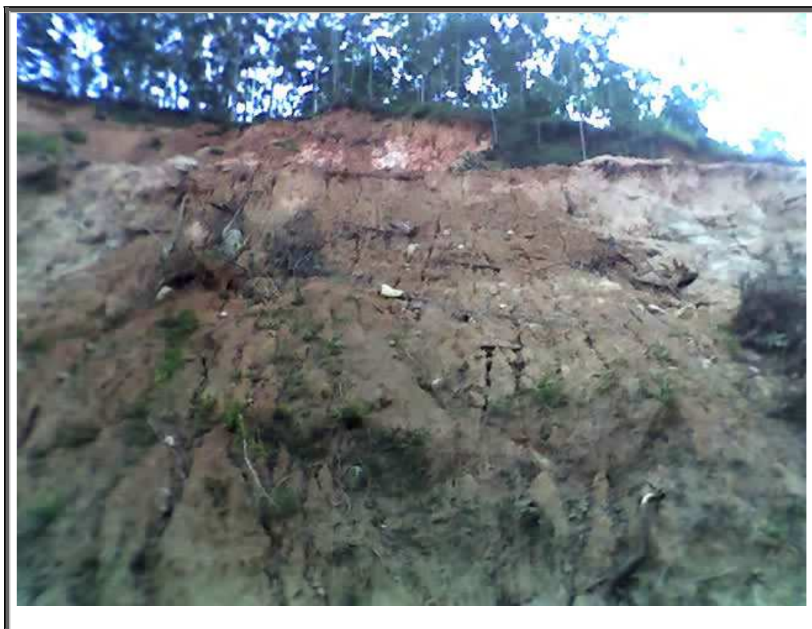
Figura 5.18 – Perfil de alteração em solo residual, Estrada Granja Spinelli (abr/2008).
