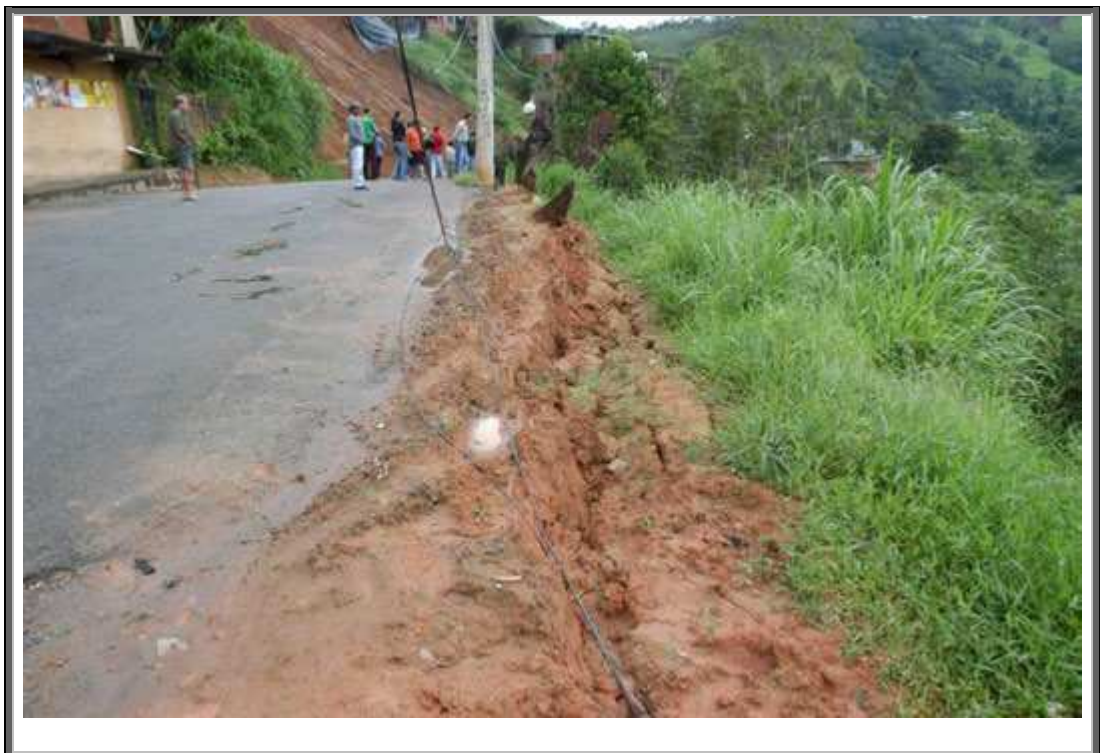
Figura 5.25 – Deficiência do sistema de drenagem de águas pluviais, ausência de guias e sarjetas, Jardim Califórnia (Fonte: Defesa Civil, 2007).
