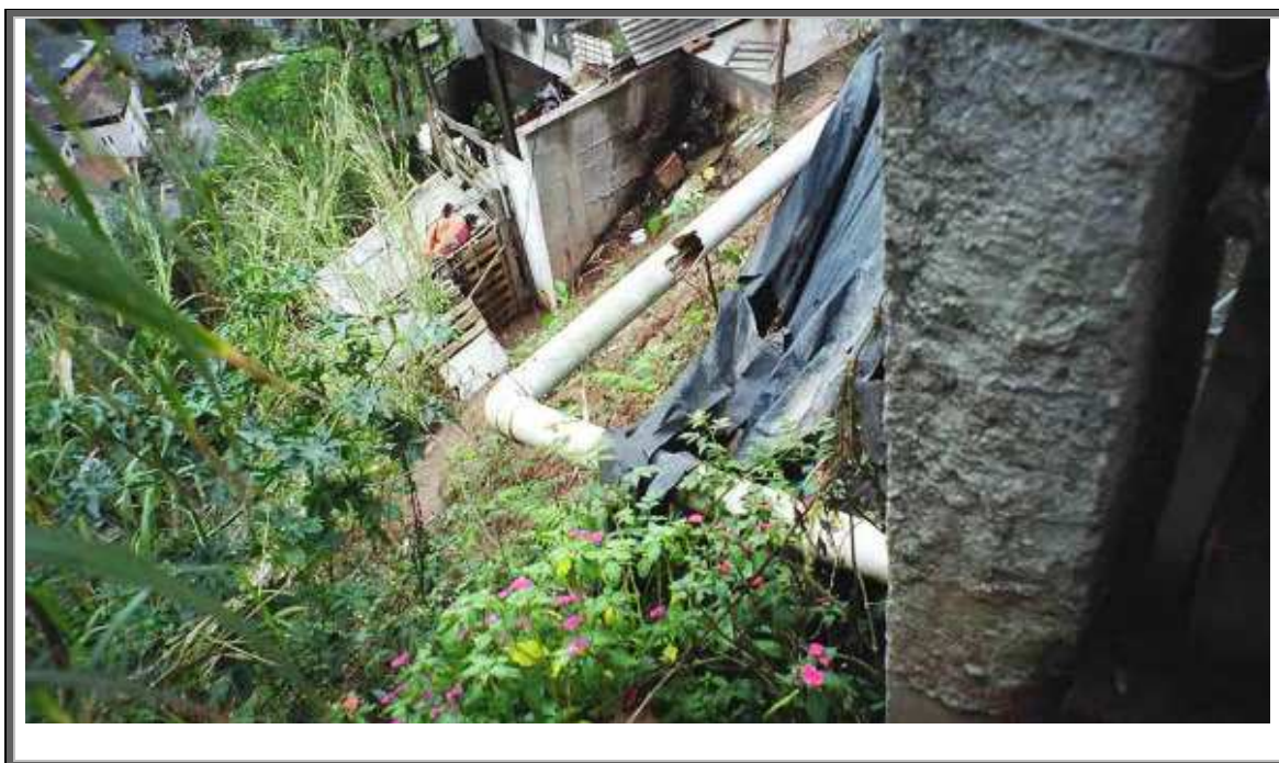
Figura 5.26 – Precariedade da coleta do esgoto domiciliar, com lançamento de águas servidas no talude (Fonte: Defesa Civil, 2007).
