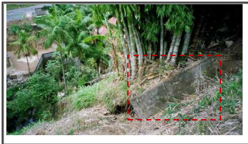
Figura 5.22 – Muro tombado, início de movimentação (Fonte: Defesa Civil, 2007).
