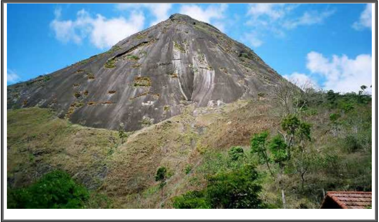
Figura 5.11 – Maciço rochoso destacando suas feições e descontinuidades estruturais localidade Barroso (Fonte: Defesa Civil, 2007).
