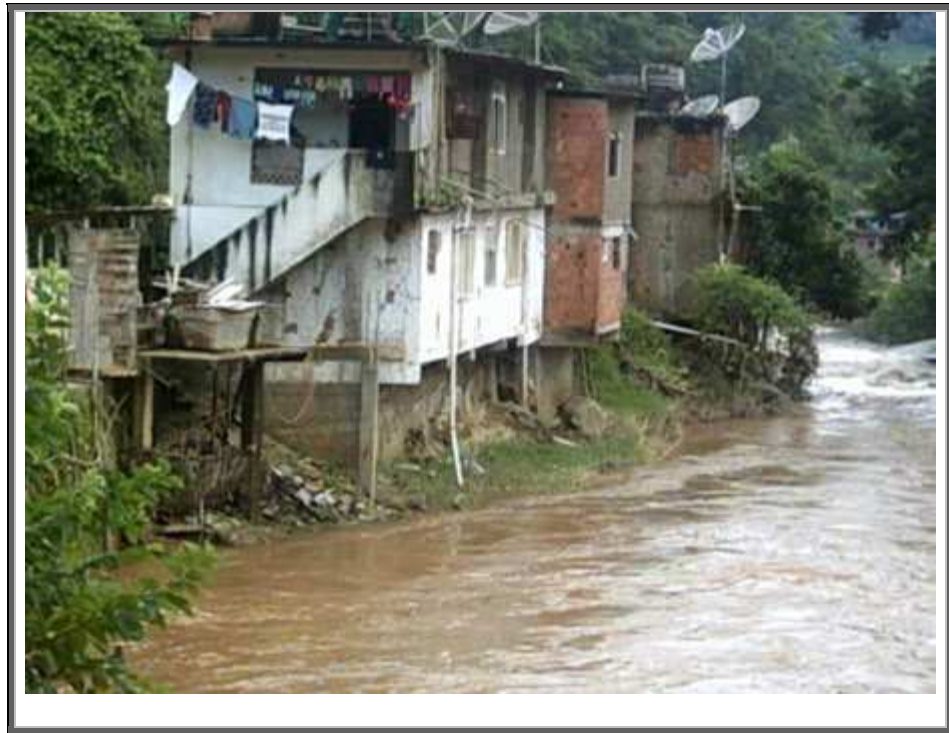
Figura 5.14 – Ocupação irregular às margens do rio Grande, janeiro de 2007, distrito de Riograndina (Fonte: Defesa Civil).
