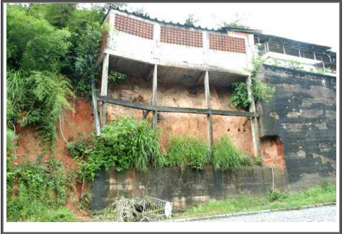
Figura 5.27 – Construção inadequada, Vila Amélia (Fonte: Defesa Civil, 2007).
