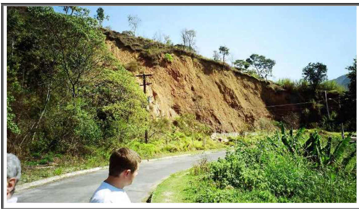
Figura 5.4 – Deslizamento em corte, via de acesso na localidade de Barroso (Fonte: Defesa Civil, 2007).
