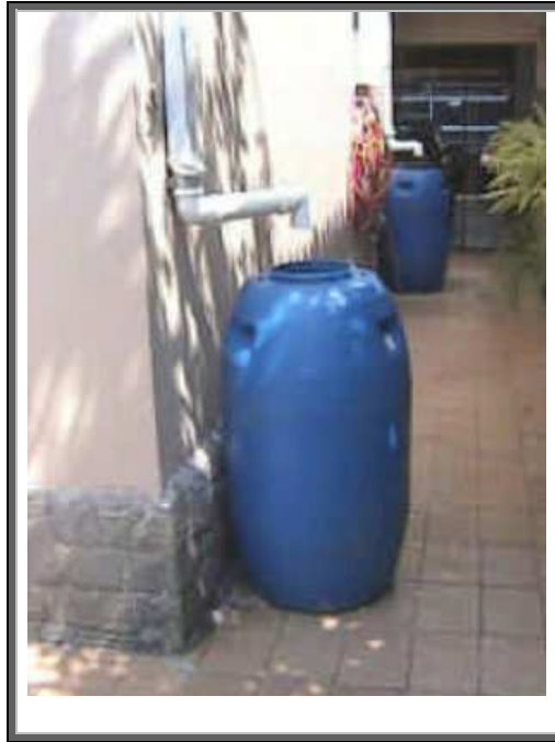
Figura 7.58 – Armazenamento de águas de chuva para reutilização, São Paulo, 1999 (Fonte: LE NOUVEAU, 2006).
