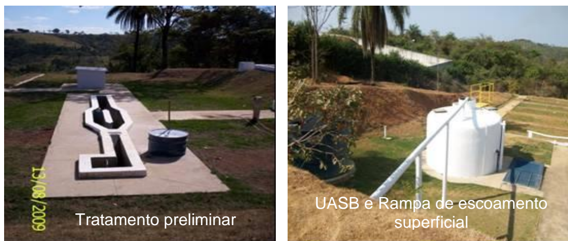
Figura 40 – Tratamento preliminar, UASB e Rampa de escoamento Superficial.
