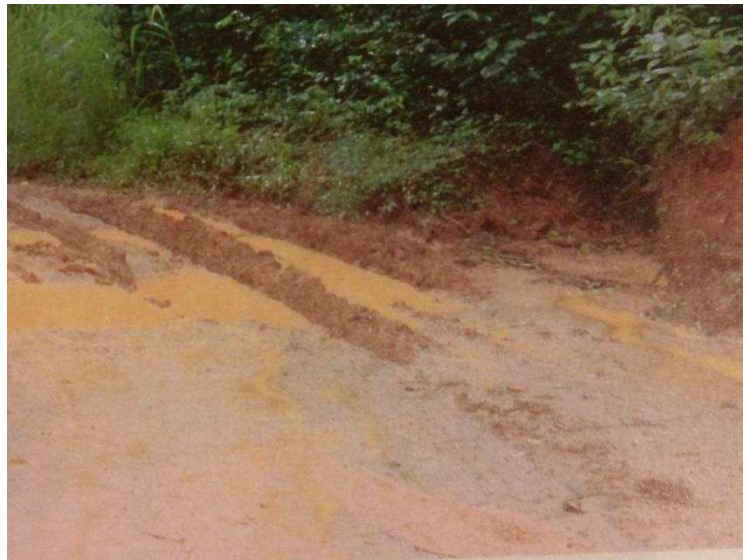
Figura 2.9 – Afundamento de trilhas de rodas
