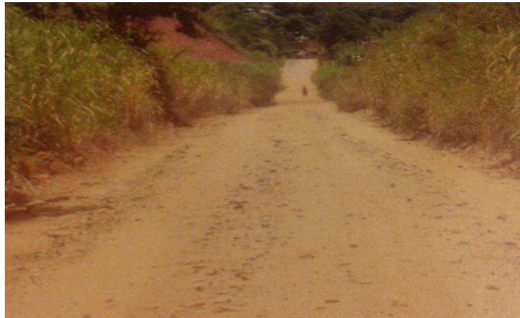
Figura 2.10 – Ocorrência de segregação de agregados
