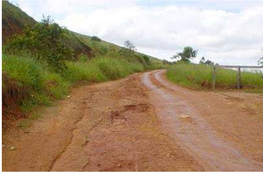
Figura 2.4 – Seção transversal inadequada
