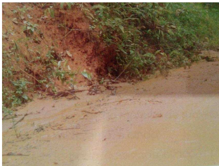
Figura 2.5 – Drenagem lateral inadequada
