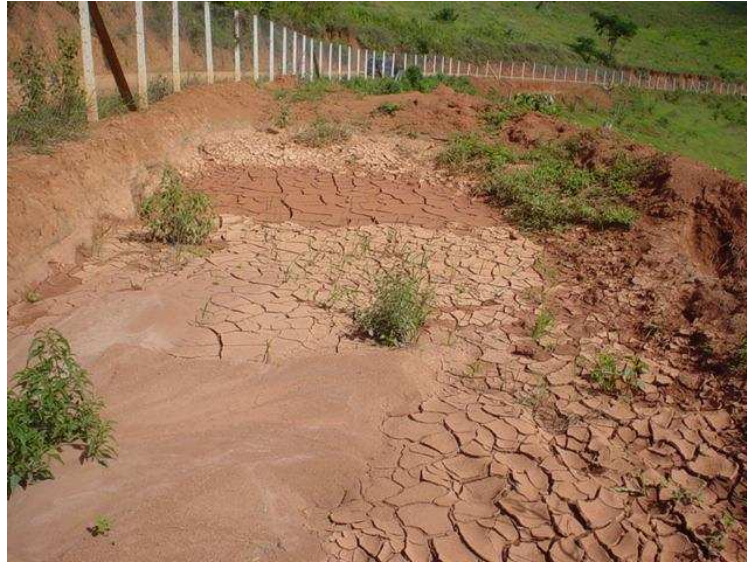
Figura 4.1 – Bacia de acumulação com eficiência comprometida devido à falta de manutenção.
