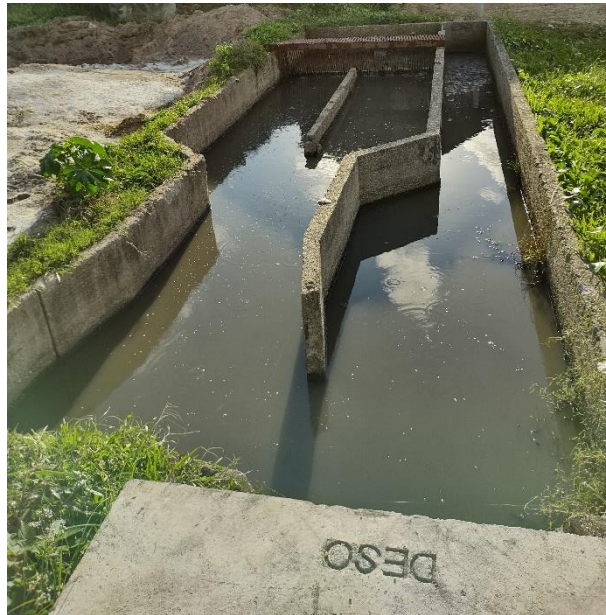
Figura 7 - Unidade de pré-tratamento da ETE.
