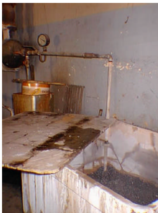
Figura 19 - Detalhe do manômetro e caixa de argamassa armada com vapor
