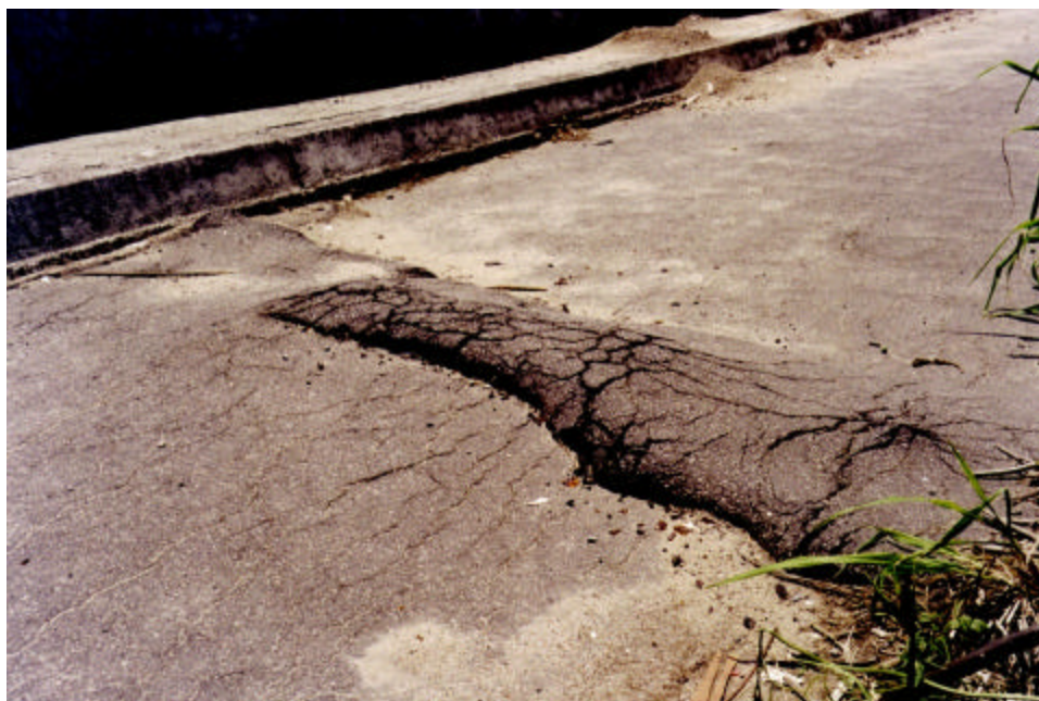
Figura 11 - Ciclovia da BR-101, onde a expansão da escória apresentou um "quebra-mola" de \pm 15 cm de altura, sendo este localizado logo atrás da boca de lobo.
