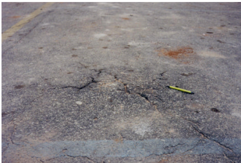
Figura 8 - Detalhe de uma trinca no pavimento com escória de aciaria.
