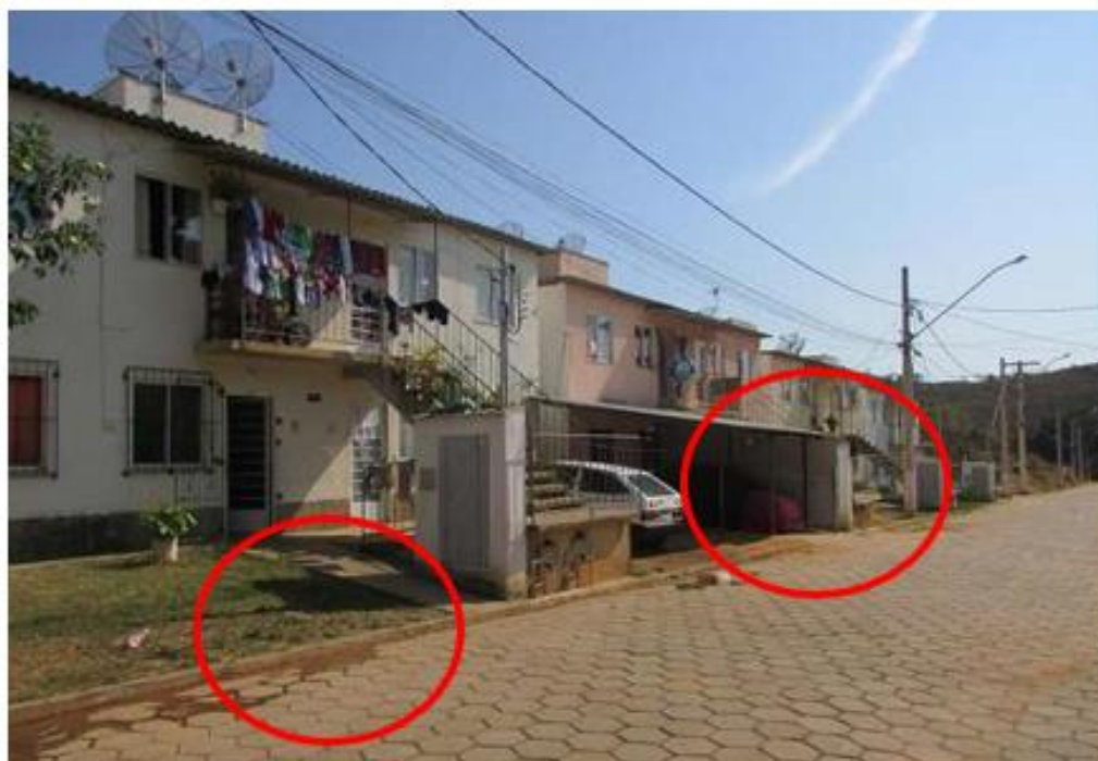
Figura 122 – Imagens do CRNM, em 2022, com as calçadas deterioradas e ocupadas pelos acréscimos das construções
