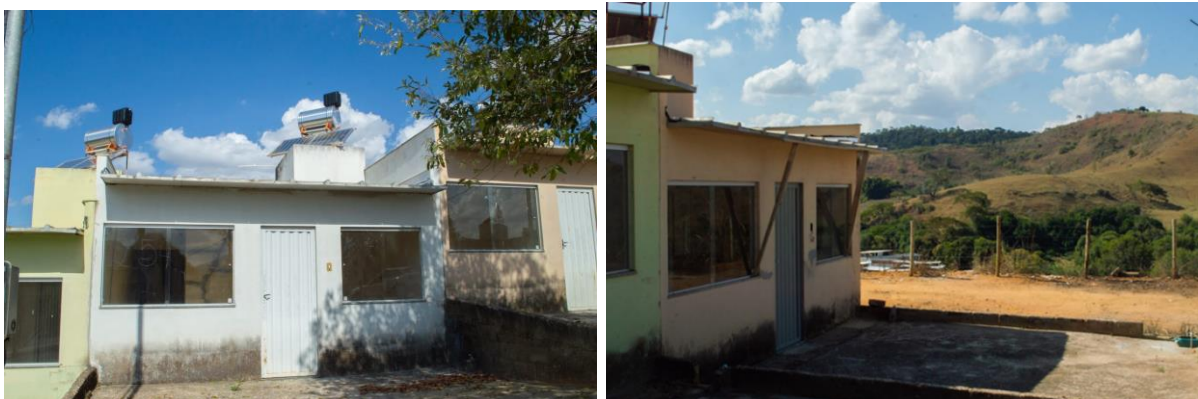
Figura 78 - Casas deterioradas após cinco anos de finalização das obras
