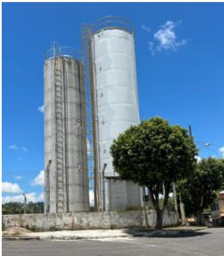
Figura 39 - Reservatórios de água da Vila do Distrito do Vermelho
