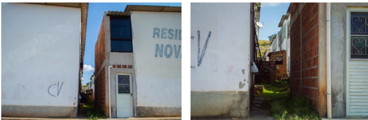
Figura 67 - Acréscimos executados nas áreas de afastamento entre os blocos. Edificações bloqueando as áreas de afastamento entre as edificações
