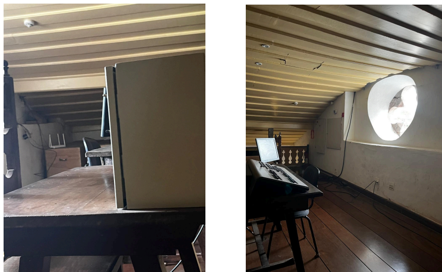
Figura 77 e 78. Cabos expostos na cabine de luz do Teatro Municipal - Casa da Ópera de Ouro Preto.
