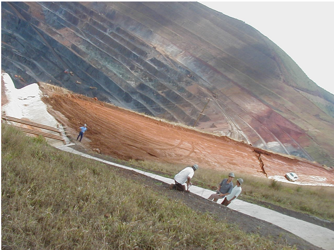
Foto 3.9 - Detalhe de ruptura no filito dolomítico da Mina do Pico (MBR/2006).
