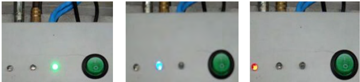
Figura 8. Luzes indicando o acionamento do servomotor.
