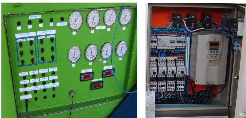
Figura 11 – Painel de controle e quadro de comando com inversor de frequência.
