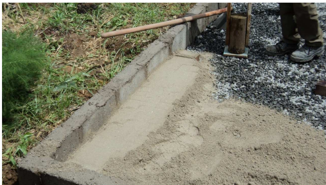
Figura 20. Compactação do pátio em solo-cimento na energia de compactação do ensaio Proctor normal
