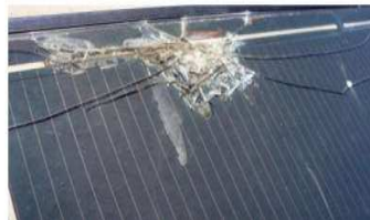
g) Degradação causada por falhas elétricas ou curto circuito gerando um arco voltaico.
