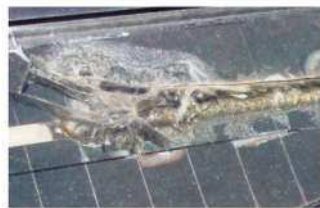
a) Delaminação ou corrosão eletroquímica, provocando ruptura.
