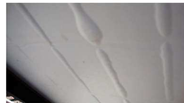
d) Delaminação ou perda de adesão do encapsulante.
