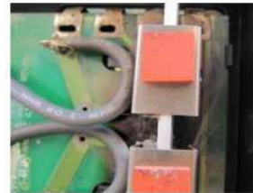
h) Deterioração e ruptura do diodo de by-pass.
