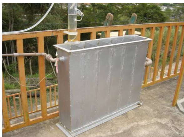
Figura 12 - ETA piloto, vista lateral do floculador.
