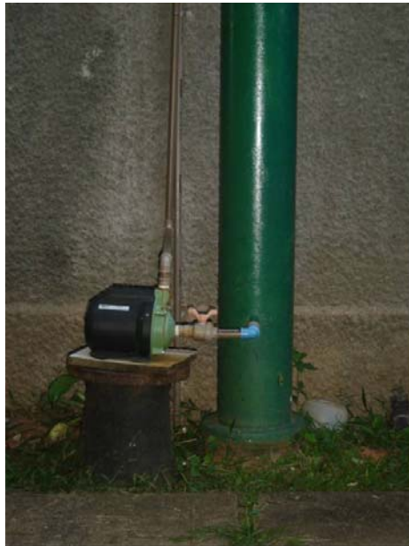
Figura 9 – Detalhe da tubulação de chegada de água bruta da ETA UFV e da tomada de água para alimentação da ETA piloto.
