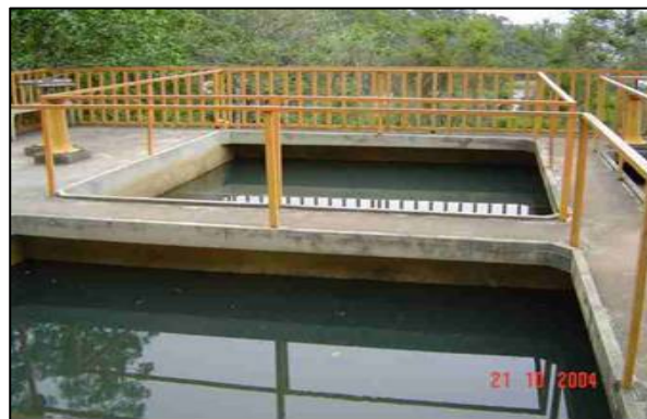
Figura 16 - ETA UFV, vista dos filtros .
