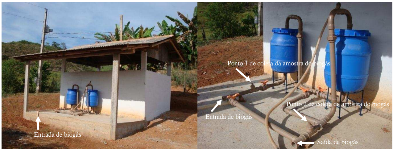
Figura 09 Vista geral do sistema de filtração.
