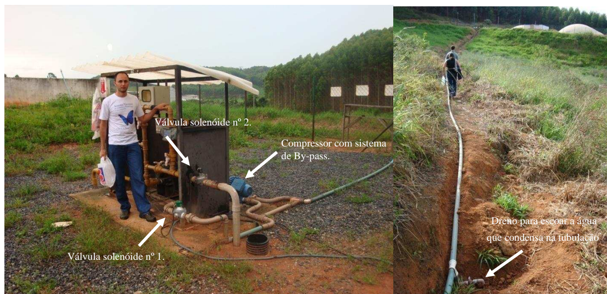
Figura 08 Localização das válvulas solenóides e compressor, para automação do sistema de distribuição do biogás e vista geral da tubulação de alimentação dos filtros.
