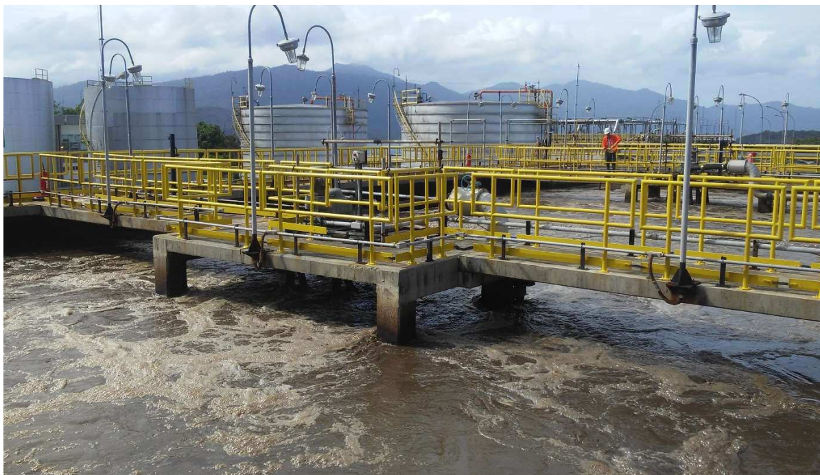
Figura 31. Reator biológico em fase de aerção de uma ETE de tratamento de água de produção em terminal aquaviário de petróleo (SOUSA, 2017).
