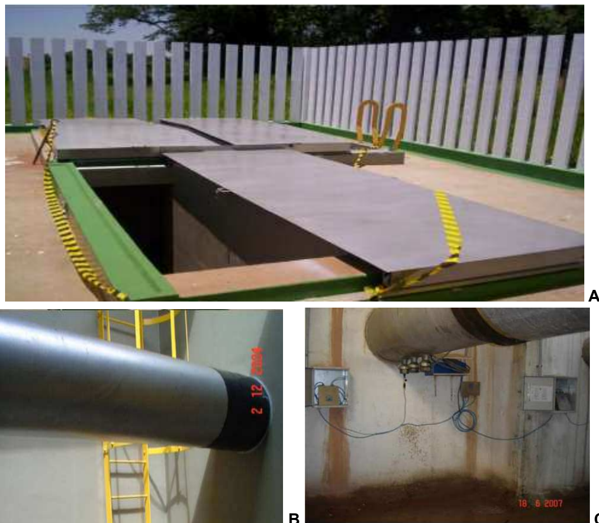
Figura 13. (A) Caixa de inspeção de uma faixa de dutos de escoamento de petróleo. (B) Trecho do duto desenterrado atravessando o interior da caixa de inspeção (escada de acesso ao fundo da imagem). (C) Sistema de monitoramento para gerenciamento da corrosão interna de dutos, o qual pode conter sonda corrosivimétrica e corpos de prova para avaliação da taxa de corrosão por perda de massa e quantificação microbiológica de biofilmes (SILVA; et al., 2008a, 2008b).
