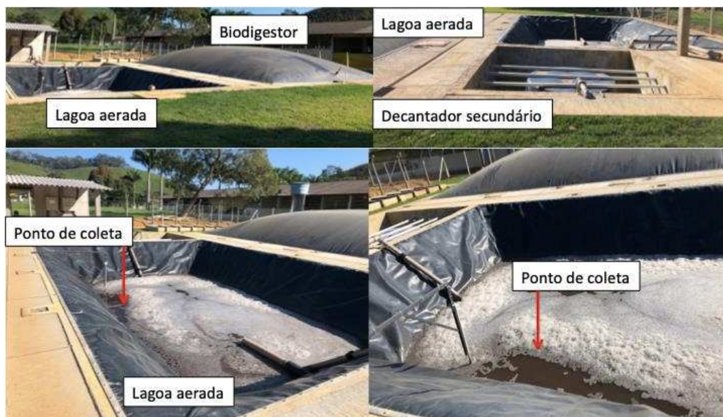
Figura 6. Estação de tratamento de efluentes da UEPE em Suinocultura UFV - unidades de tratamento e detalhe do ponto de coleta de amostras
