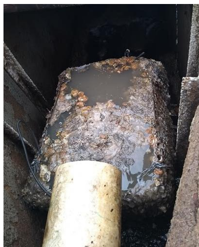
Figura 3.18 – Obstrução da unidade de gradeamento verificada na estação Romão dos Reis durante coleta realizada no dia 27/02/18.
