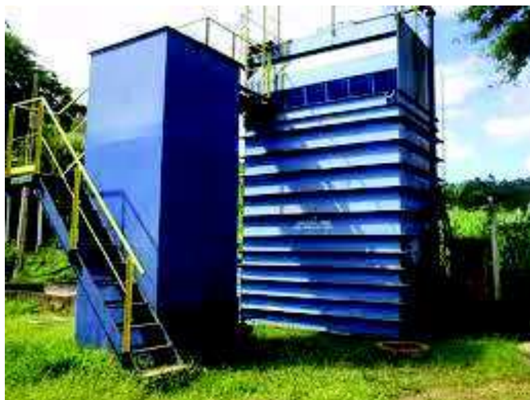
Figura 7.1 - Reator UASB da estação experimental da Violeira.
