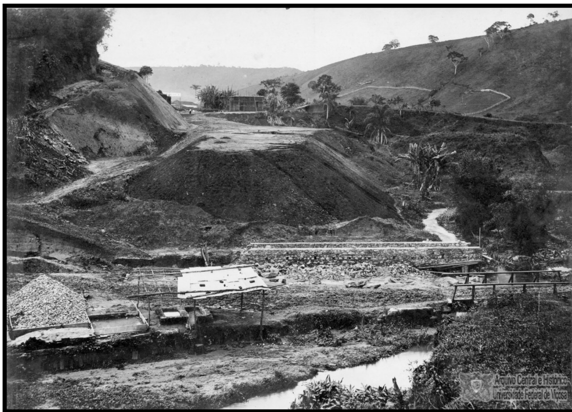
Figura 63b - Obra de construção do bueiro situado em frente às quatro pilastras
