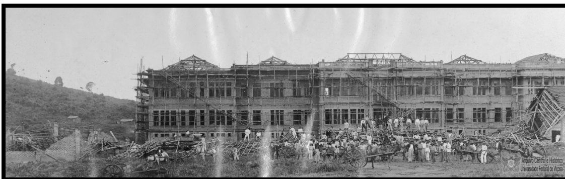
Figura 35b - Edifício principal em fase de colocação das cumeeiras e o barracão da obra derrubado em forte temporal
