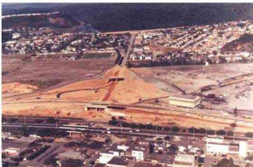
Figura 13 - Vista parcial de Ipatinga durante a construção do mergulhão sob a BR-381.
