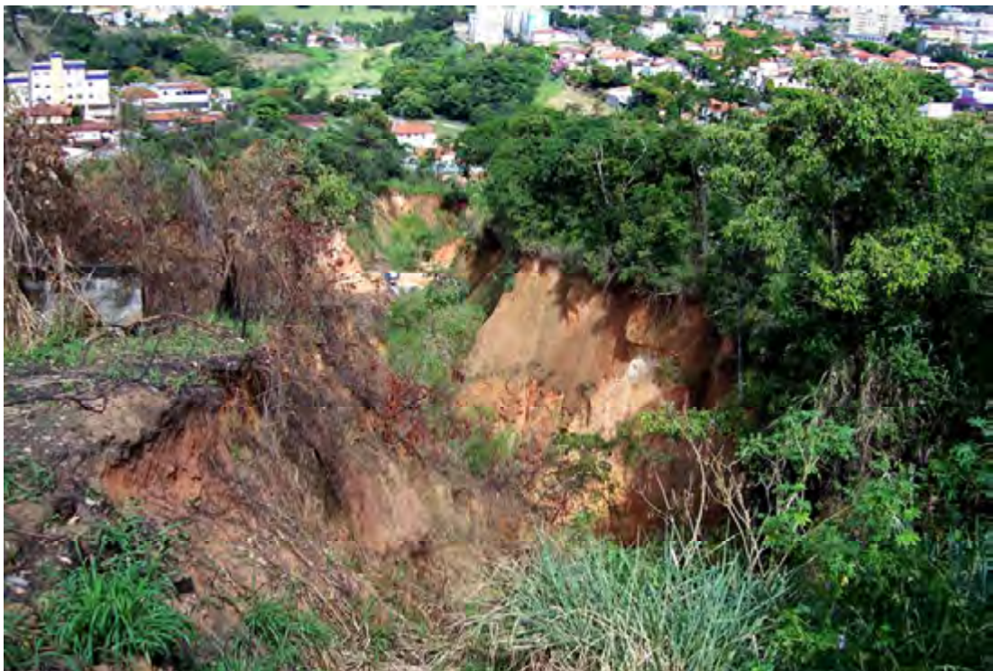
Figura 5.5 – Possibilidade de escorregamento das paredes de voçorocas, presentes no Complexo Belo Horizonte (quadrícula K8 da Figura 5.3).
