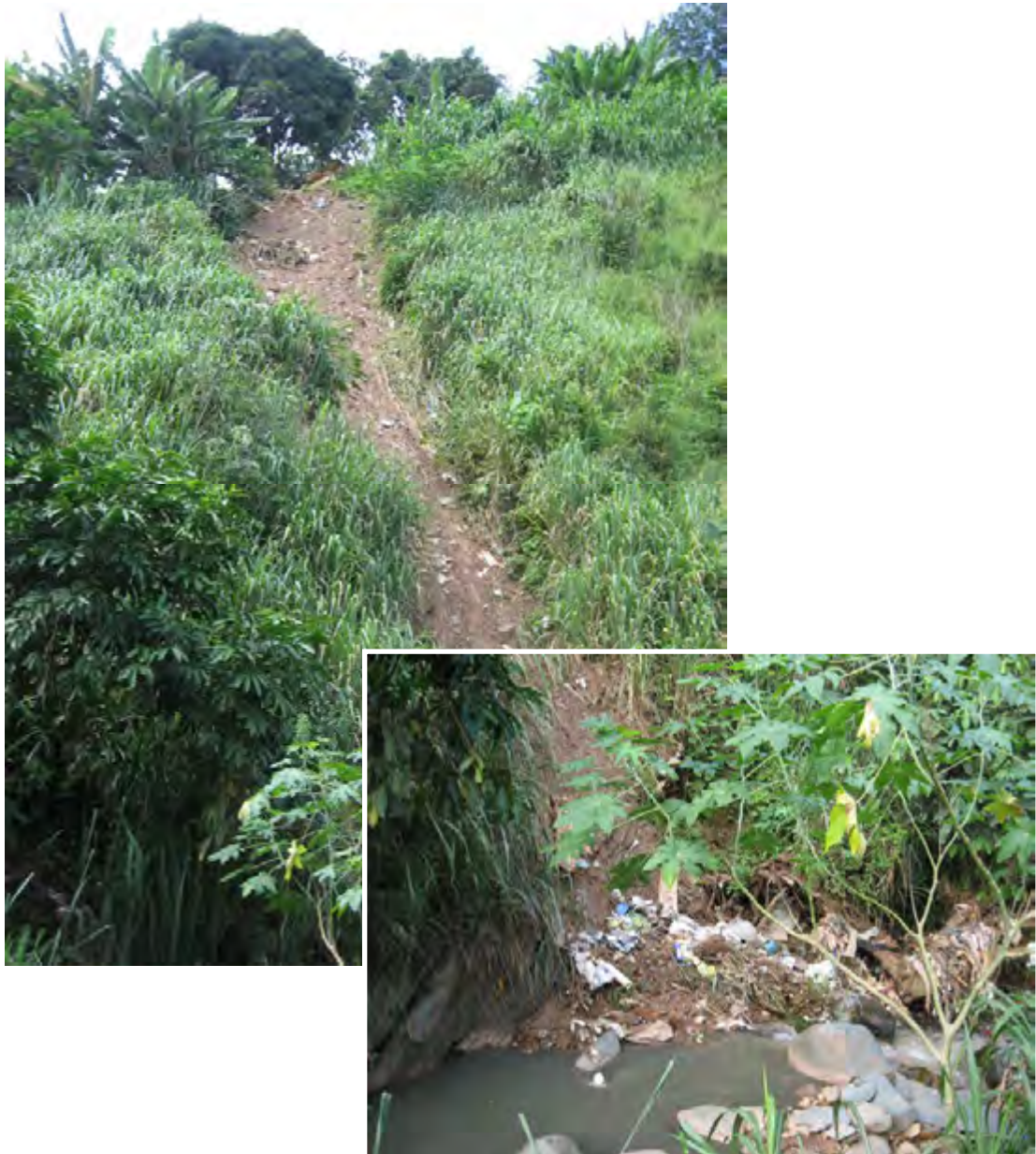
Figura 3.19 – Lançamento frequente de lixo e de solo descartado nas encostas, ocasionado o escorregamento destes materiais inconsolidados.
