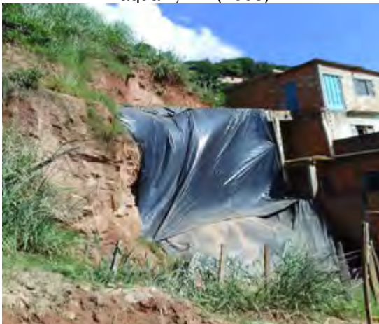
c) Corte com geometria inadequada, observada no Conjunto Taquaril, BH (2008).
