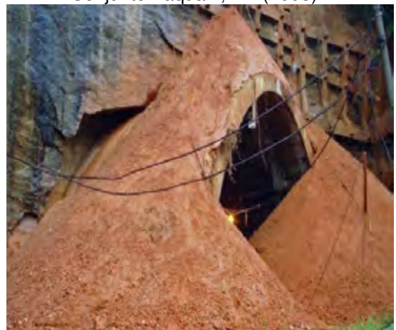
d) Lançamento e concentração de águas pluviais e/ou servidas – possível causa no deslizamento de terra no túnel Rebouças (RJ) (2007).
