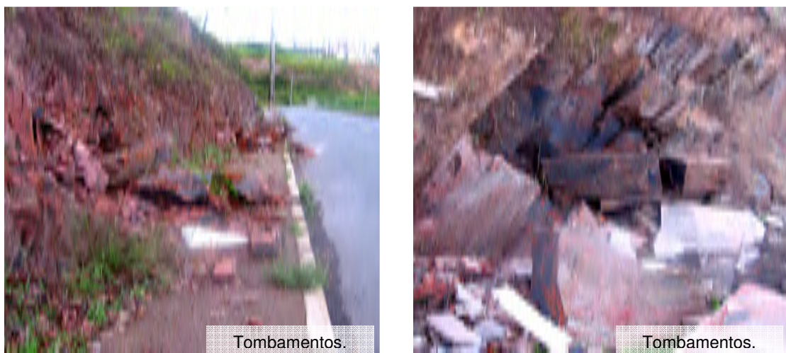
Figura 3.9 – Queda de blocos e detritos no Quartzito da Formação Cercadinho.
