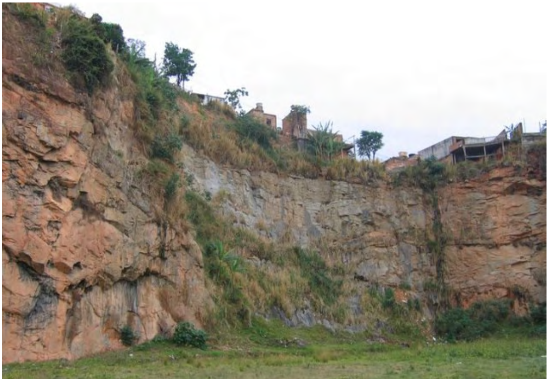
Figura 5.7 – Pedreira no bairro Engenho Nogueira, em gnaiss muito fraturado com possibilidade de queda de rocha e detritos (quadrícula H4 da Figura 5.3).
