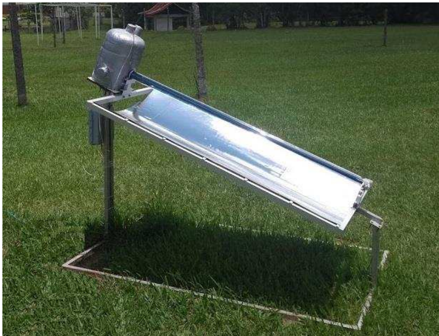
Figura 10. PTC instalado na área experimental.
