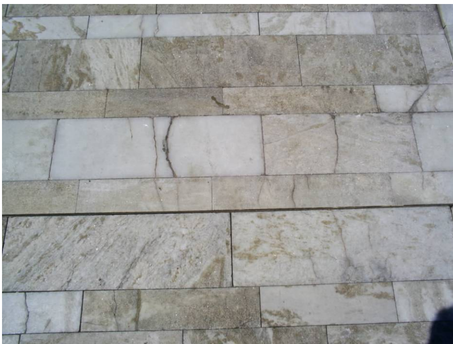
Figura 6 – Rampa de acesso ao Congresso Nacional (Brasília/DF). Pode-se observar a ação do tempo no piso, com consequente surgimento de trincas.
