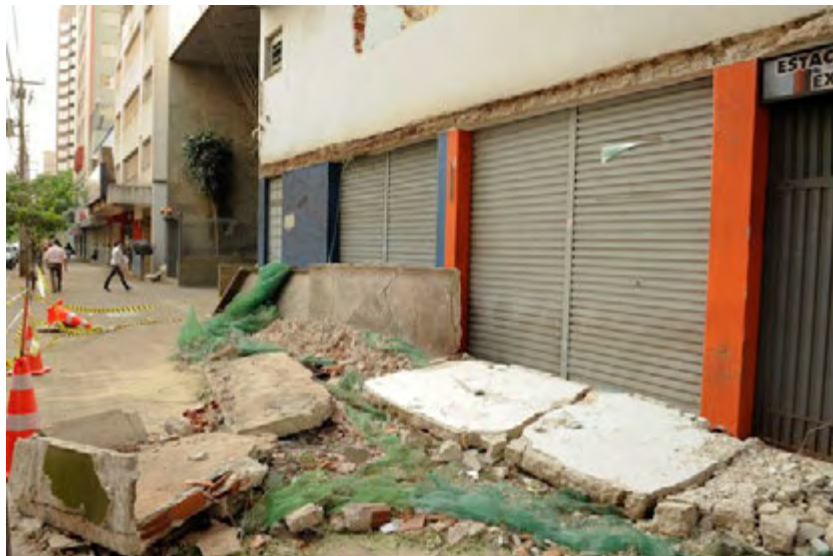
Figura 3. 16 - Queda de marquise em Maringá. Fonte: http:// www .jornal de londrina . com.br . Acesso: Setembro 2010
