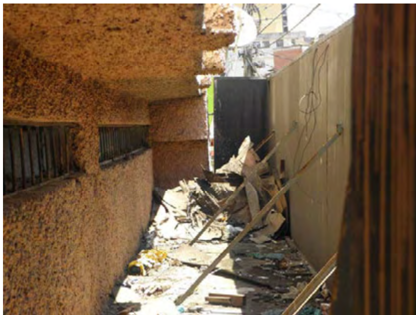
Figura 2. 14 -Exemplo de marquise com falta de manutenção.
