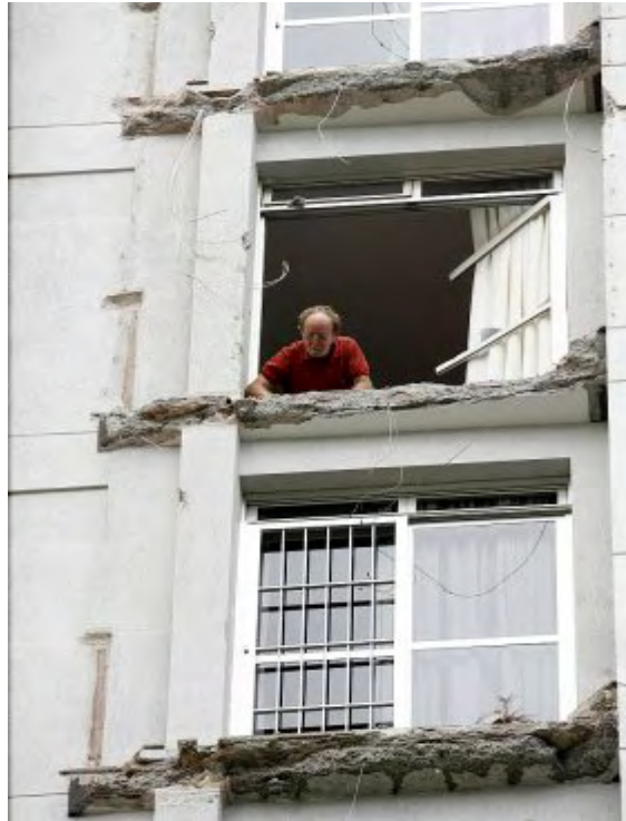
Figura 3. 17 - Desabamento de marquise em Maringá 2008. Marquise desaba sobre 15 sacadas. Fonte: http://www.gazetadopovo.com.br . Acesso: Setembro 2010.
