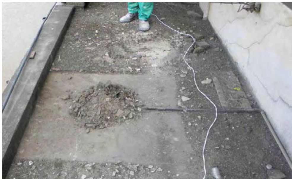
Figura 16: separação de trecho de 1 m 2 e recolhimento de material em seu estado natural.
