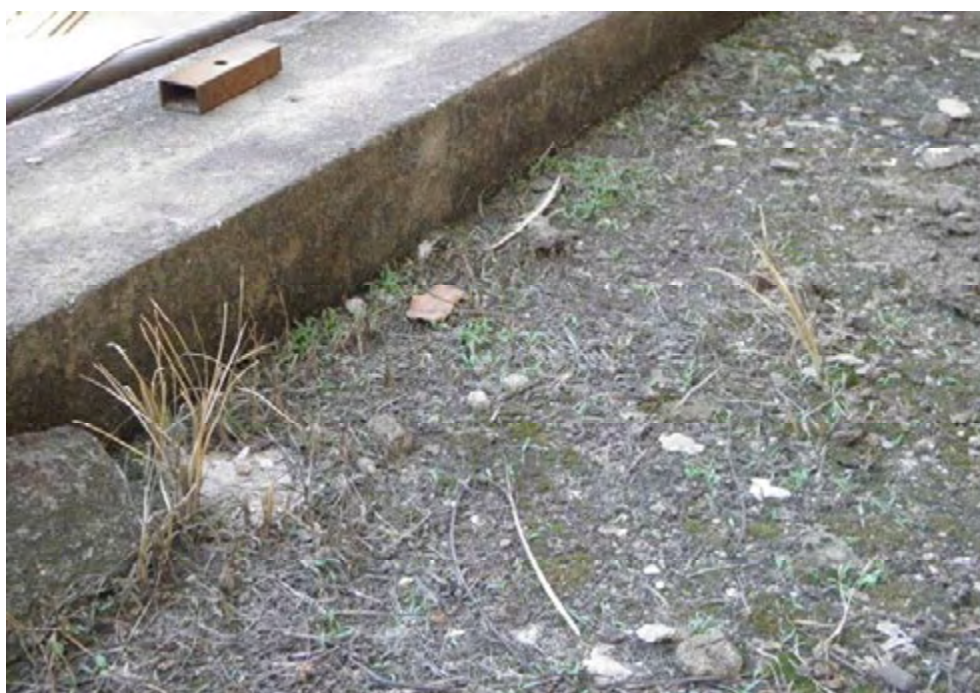
Figura 15: Crescimento de vegetação e acúmulo de detritos.
