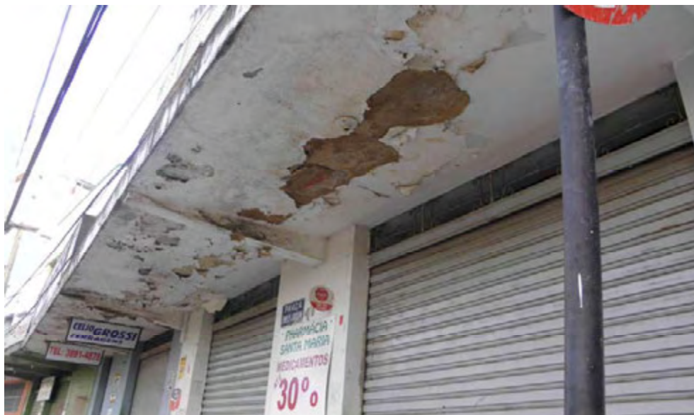
Figura 7: camada de revestimento inferior – deterioração de pintura e revestimento
