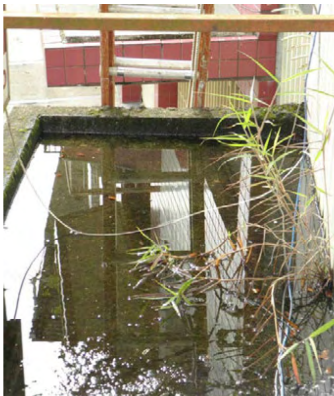
Figura 2. 6 - Exemplo de sistema de drenagem obstruído em marquise.
