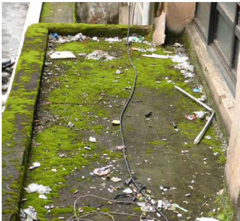
Figura 4. 8 – Acúmulo de limo e entupimento de sistema de drenagem por falta de manutenção ( Marquise MB 135).
