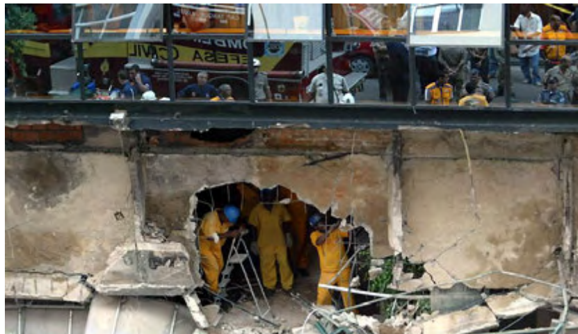
Figura 3. 3 - Desabamento de marquise Hotel Canadá. Fonte: http://oglobo.globo.com/rio . Acesso: Outubro 2010.
