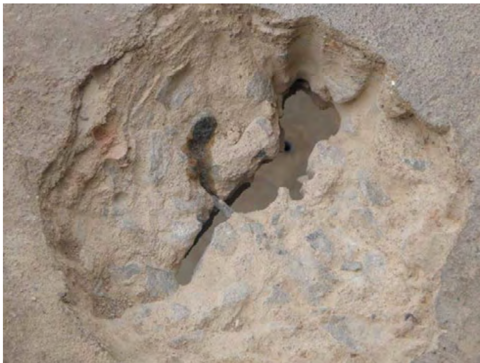
Figura 11: Verificação de carbonatação no concreto por aspersão de solução de fenolftaleína.
