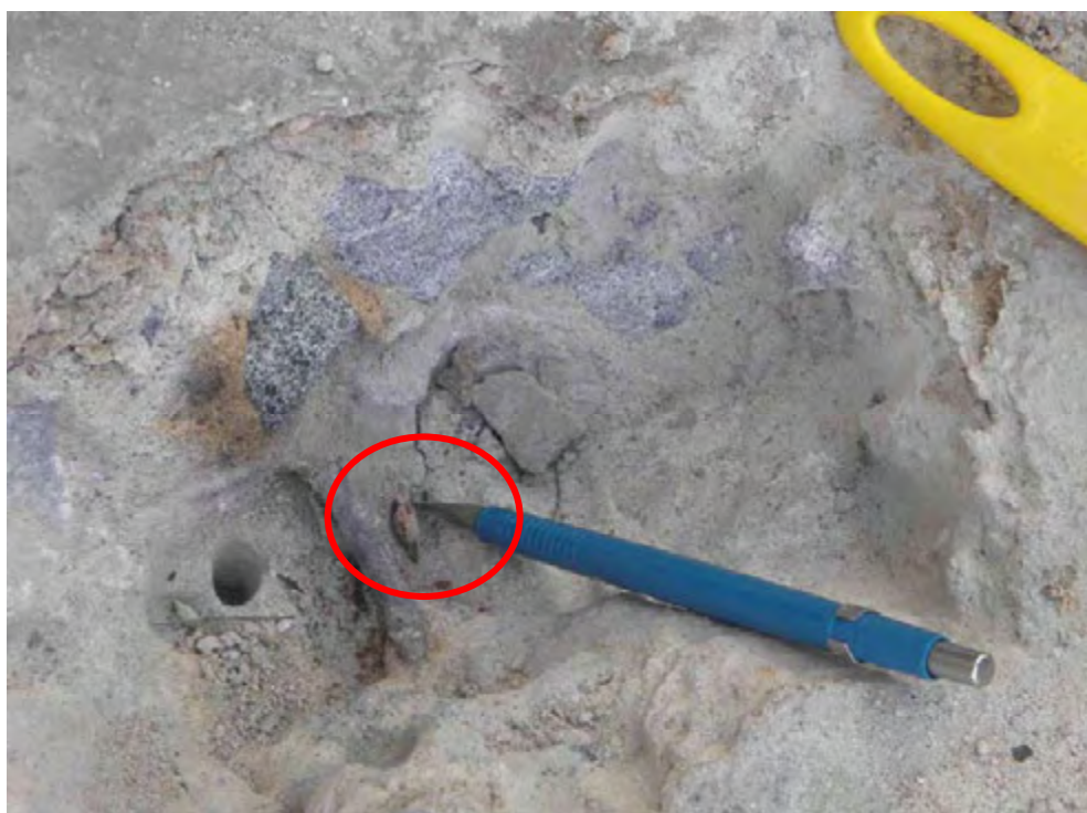
Figura 13: armadura em processo de corrosão com perda de seção – detalhe: fragmento de armadura.
