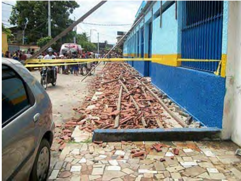
Figura 3. 15 - Queda de marquise, Escola Municipal Wilson Simões , Caxias, RJ. Fonte: http://albertomarques.blogspot.com . Acesso: Agosto de 2010
