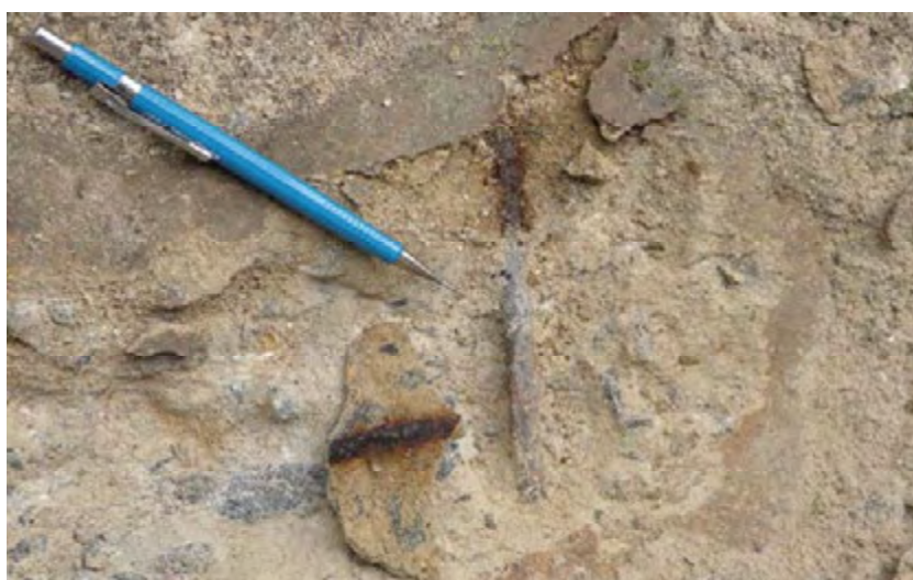
Figura 4. 17 – Armadura com corrosão com perda de seção, agravada por cobertura insuficiente.
