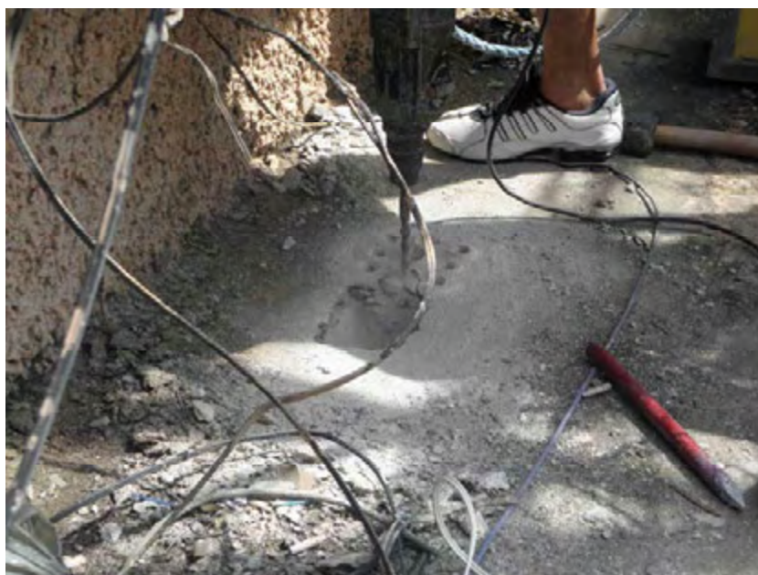
Figura 4. 12 – Detalhe de inspeção com auxílio de furadeira e ponteiro de aço para pequenas remoções de material (Marquise JCR 158).
