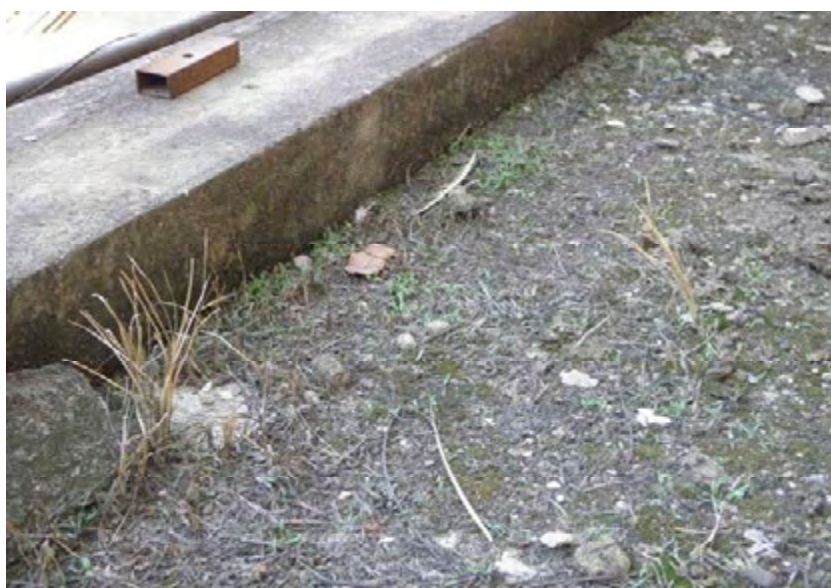
Figura 4. 9 – Exemplo de crescimento de vegetação por falta de manutenção (Marquise PEJ 79)
