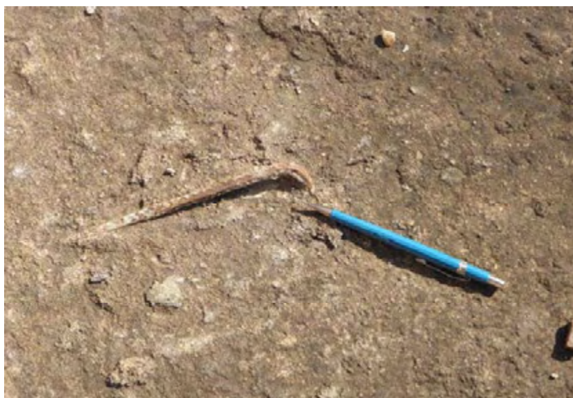
Figura 2. 13 - Exemplo de mau posicionamento de armadura. Posicionamento acima do concreto.
