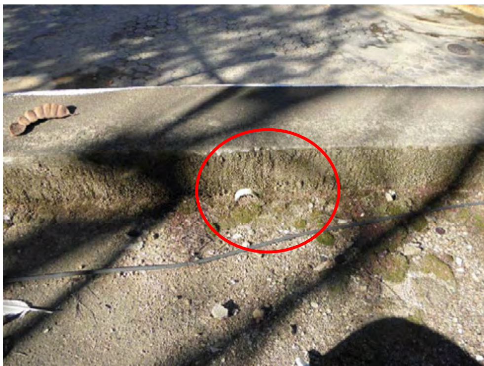
Figura 14: sistema de drenagem em tubos de PVC obstruído por lime e detritos.
