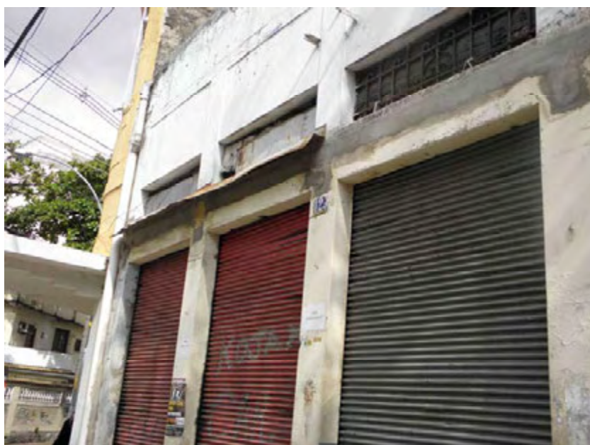
Figura 3. 22 - Exemplo de marquise totalmente removida.
