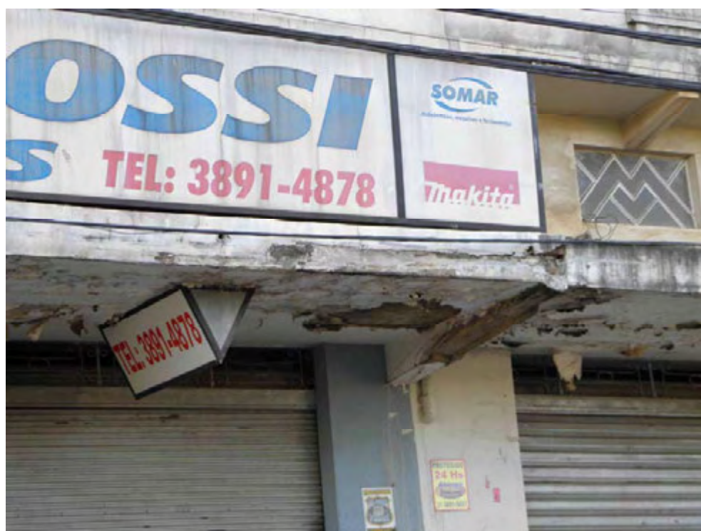
Figura 6: Danos à borda da marquise devido a choques de veículos altos.
