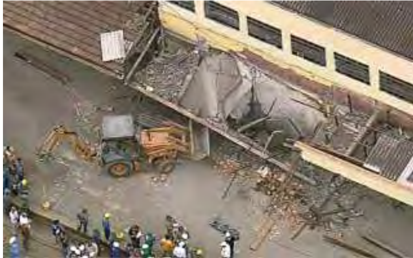
Figura 3. 14 - Queda de marquise Cais do Porto 2007. Fonte: http://g1.globo.com/Noticias . Acesso: Agosto de 2010.
