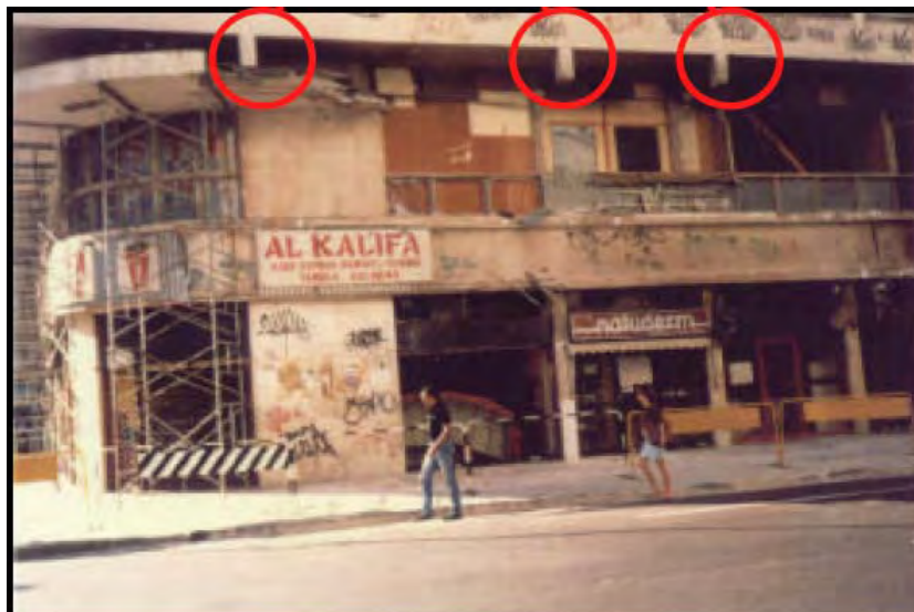
Figura 3. 5 - Marquise do edifício Mercúrio após desabamento: detalhe dos tirantes de apoio. (JORDY e MENDES 2006)
