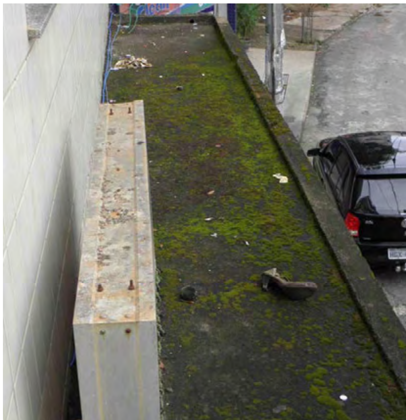
Figura 4. 7 - Camada de revestimento superior com variação de espessura—marquise MB 355.
