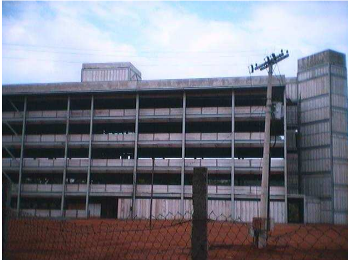
Figura 105 - Elevação do fechamento externo do Edifício do CCB-II com painéis de concreto celular autoclavados.
