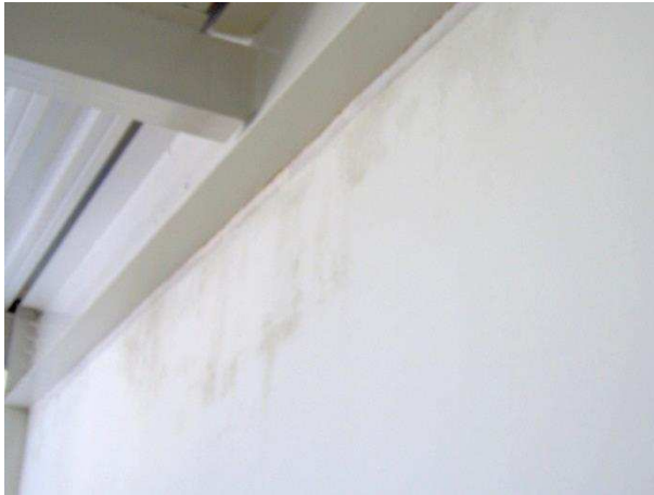
Figura 23- Presença de manchas na alvenaria interna, próximas ao perfil metálico.
