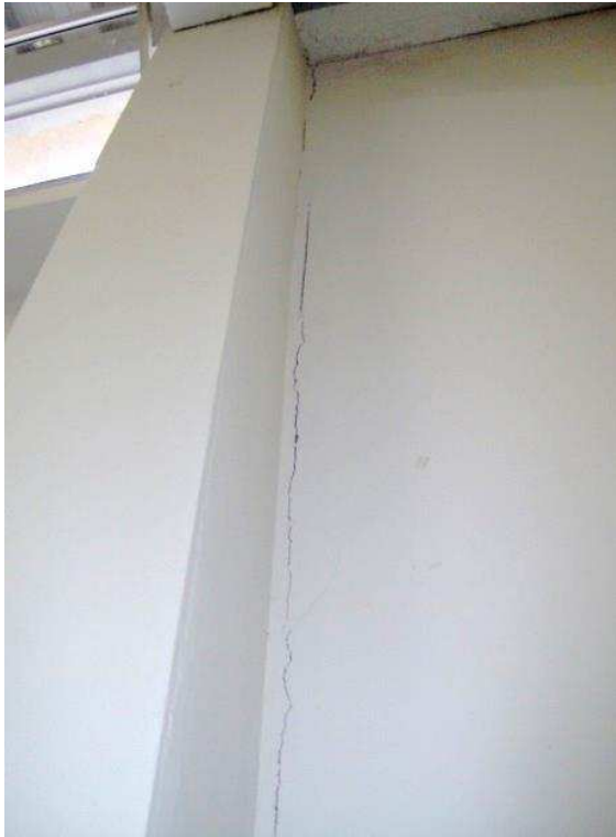
Figura 21- Fissura na alvenaria interna.
