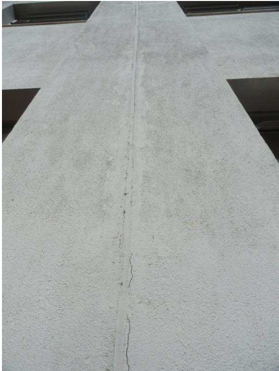
Figura 27- Junta de movimentação na fachada com o selante comprometido.
