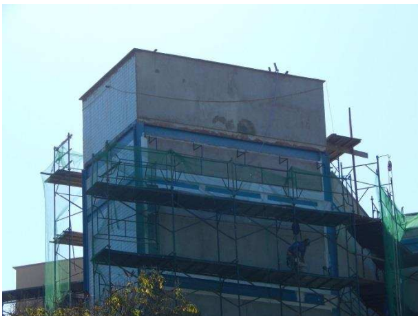
Figura 157 – Experimento montado novamente na parte superior da caixa de escada.
