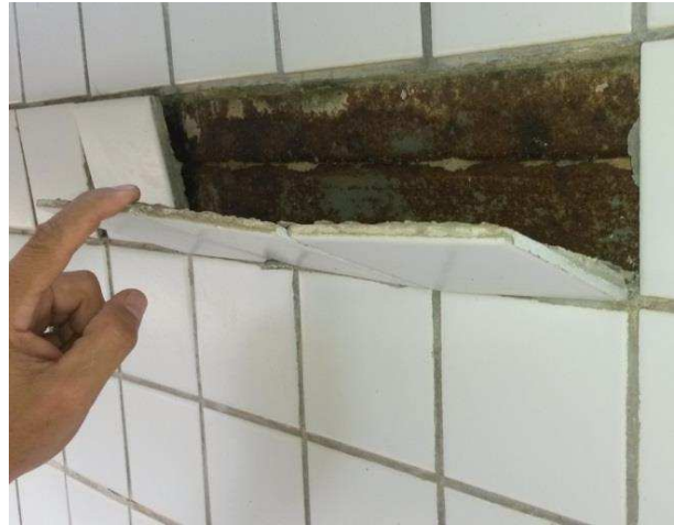
Figura 114 – Corrosão causada pela presença de água e umidade permitida pela expulsão do revestimento cerâmico.
