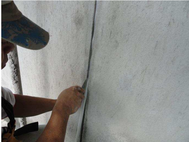
Figura 14 - Colocação do corpo de apoio de polietileno expandido na junta de movimentação.
