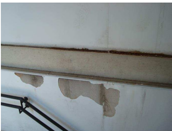
Figura 110- Desprendimento do gesso de revestimento interno na caixa de escada.
