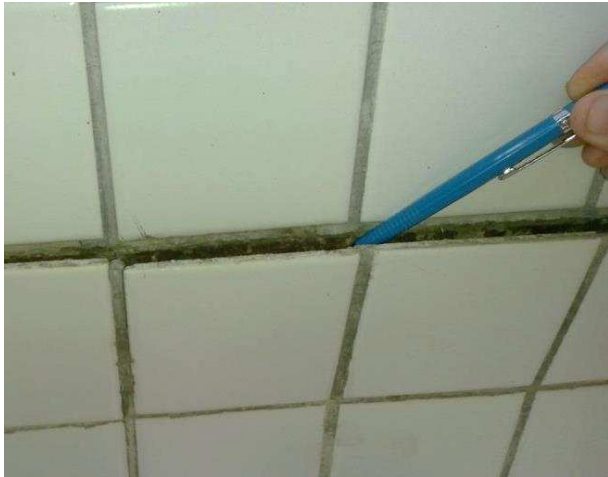
Figura 113 – Desprendimento do revestimento cerâmico aplicado sobre as cantoneiras de aço.
