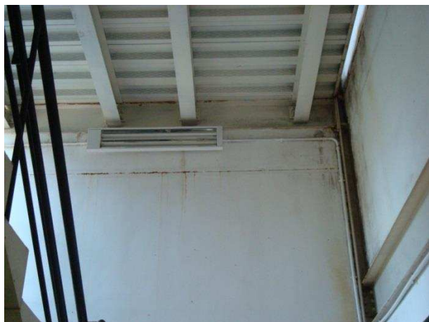
Figura 107 - Manchas de umidade e corrosão observadas no interior da caixa de escada do Edifício do CCB-II.
