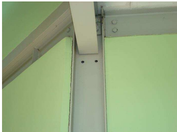
Figura 26- Degradação da interface entre a alvenaria interna e o pilar de aço.
