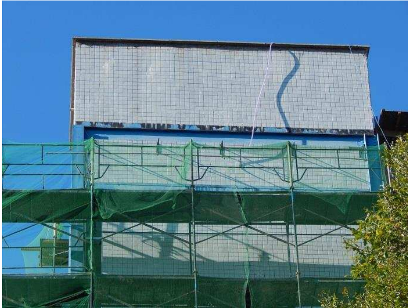
Figura 144 - Dispositivo posicionado na fachada.
