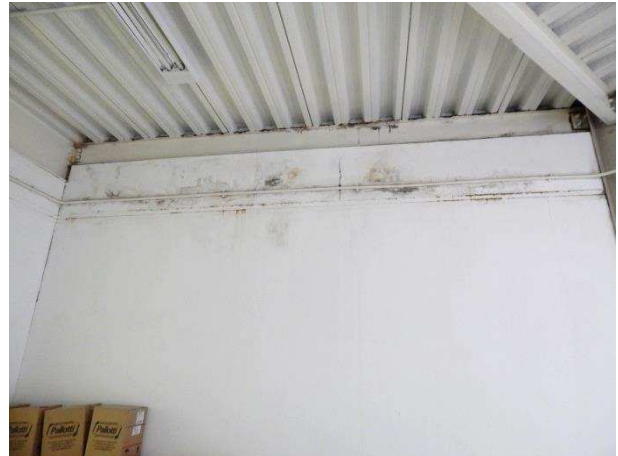
Figura 24- Presença de manchas na alvenaria interna, próximas à instalação elétrica.
