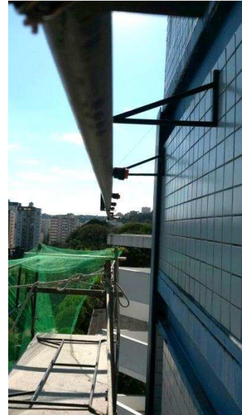
Figura 145 - Detalhe do dispositivo fixado na fachada.
