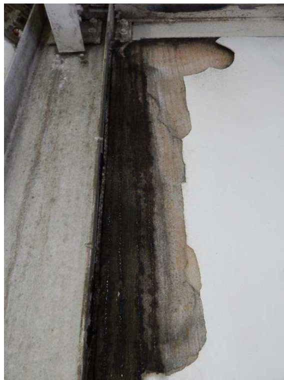
Figura 153 – Presença de água na superfície interna.
