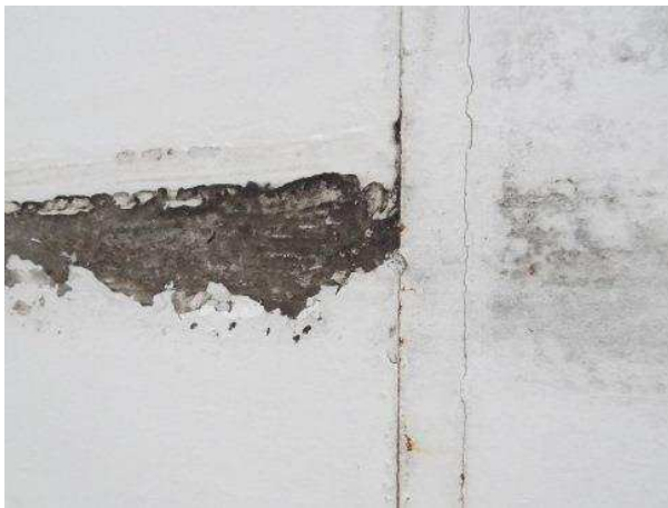
Figura 25- Degradação da interface entre a alvenaria interna e a cantoneira de aço.
