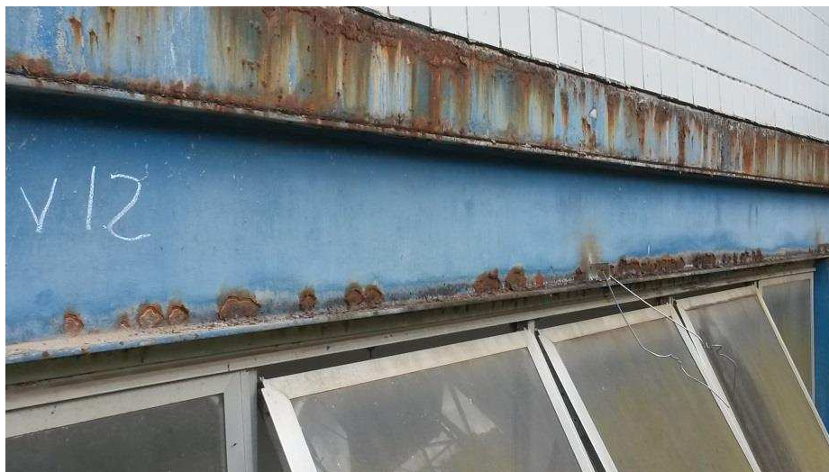
Figura 115 – Elevado grau de corrosão na interface do arremate lateral do steel deck com a alvenaria e com a viga de aço.
