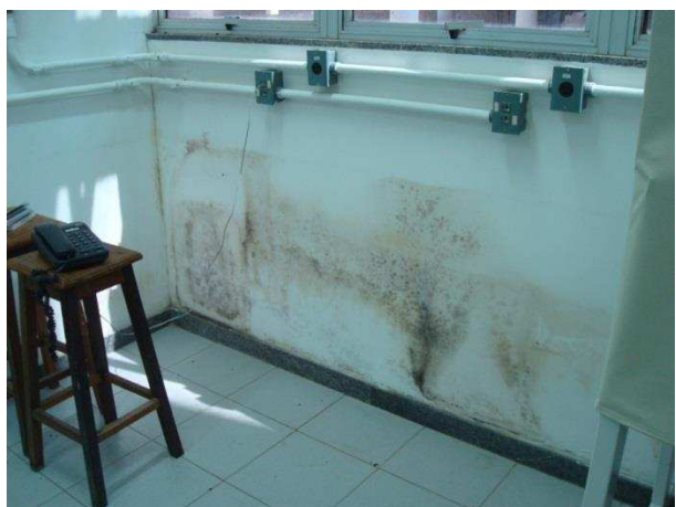
Figura 109- Manchas de mofo e umidade no interior de um laboratório.
