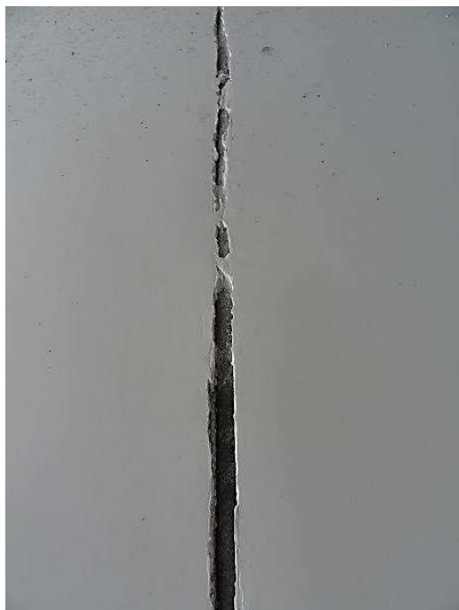
Figura 54 – Superfície irregular de uma junta de movimentação onde será aplicado o selante.
