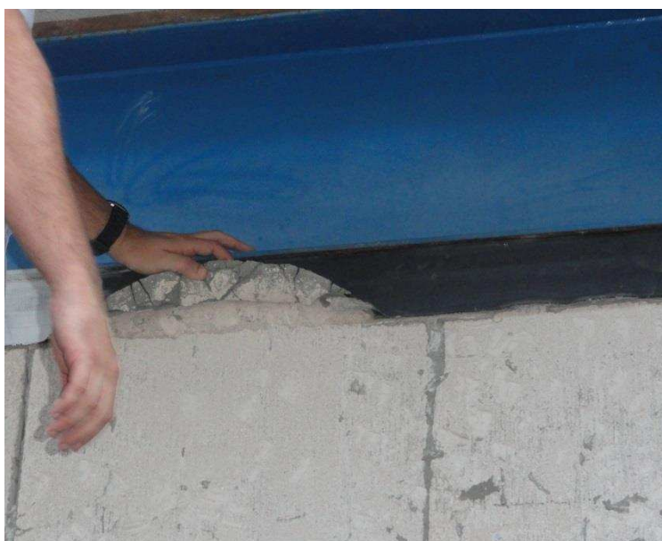
Figura 127- Perda de aderência entre p bloco de concreto celular autoclavado e a manta EPDM.
