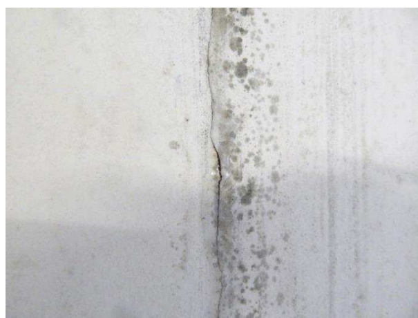
Figura 155- Fissura que permite a entrada de água.
