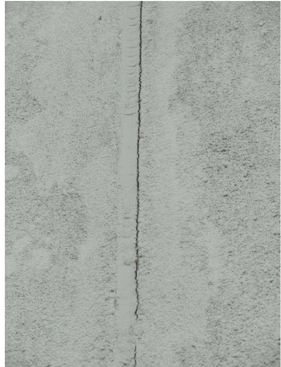
Figura 28- Detalhe do selante comprometido pela perda de adesão com o substrato.
