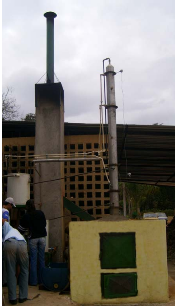
Figura 8 – Coluna de destilação instalada sobre a fornalha de fogo direto.
