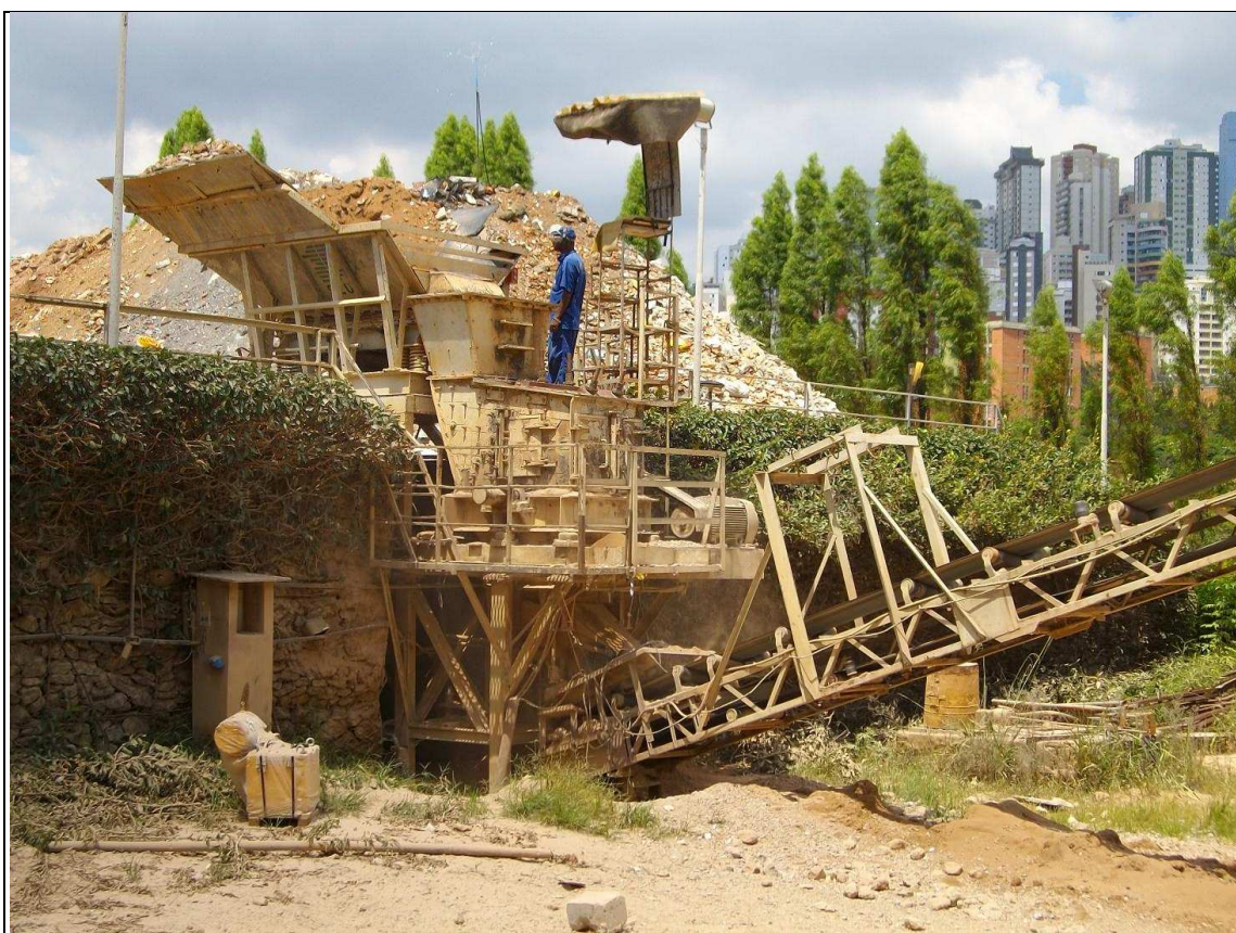
Figura 10 – Vista do britador
