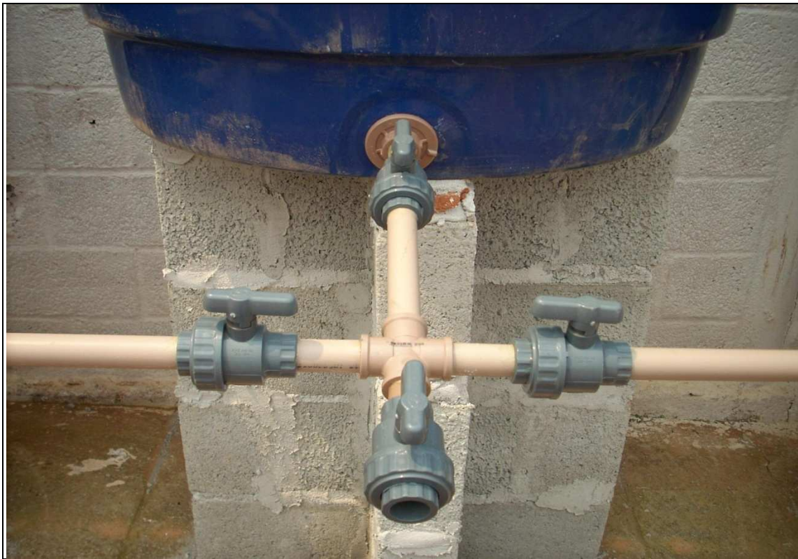
Figura 27 – Detalhe do grupo de registros para coleta de efluente dos reservatórios intermediários
