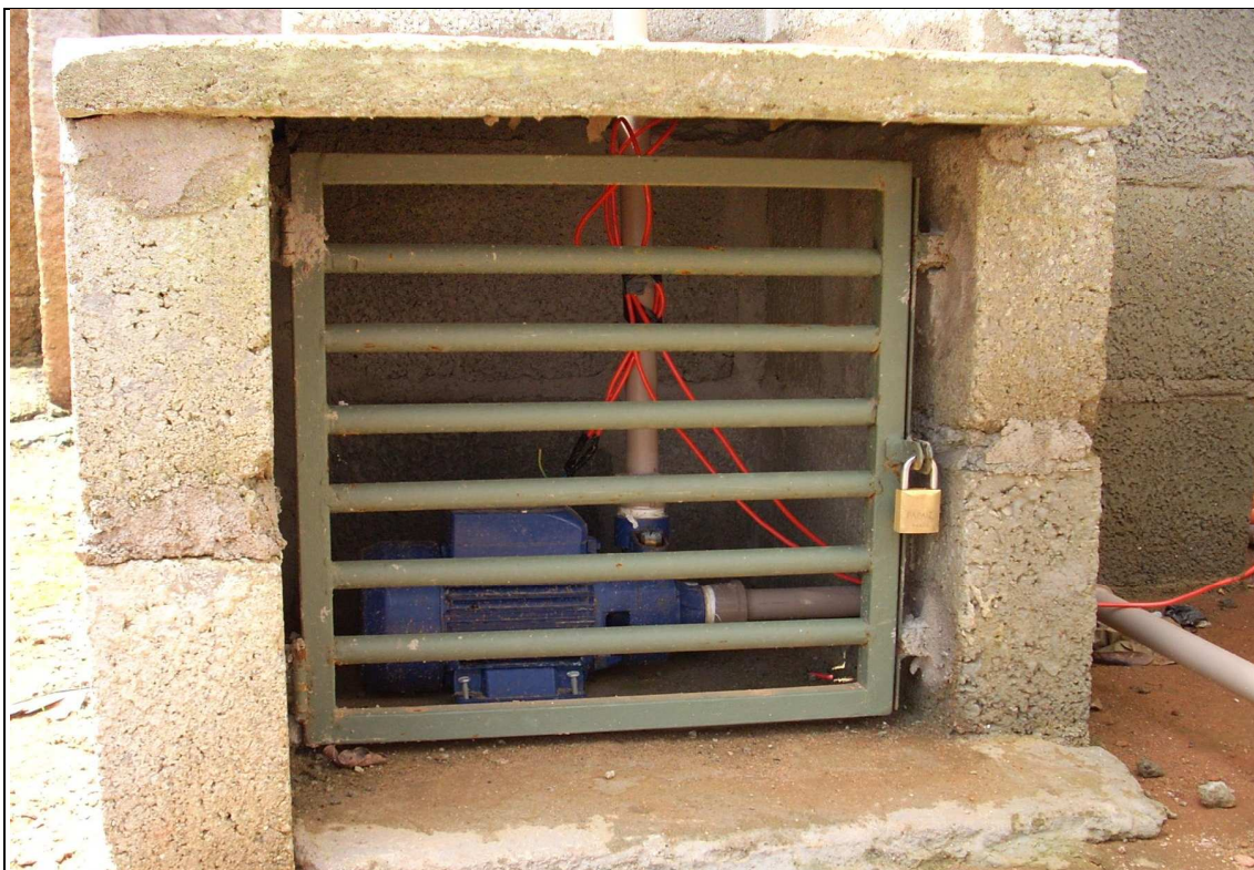
Figura 26 – Bomba utilizada para transferência do lixiviado do reservatório inferior para o superior
