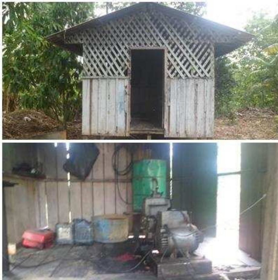
Figura 8 - Local e o gerador de energia comunitário da comunidade Barreira do Tambaqui.
