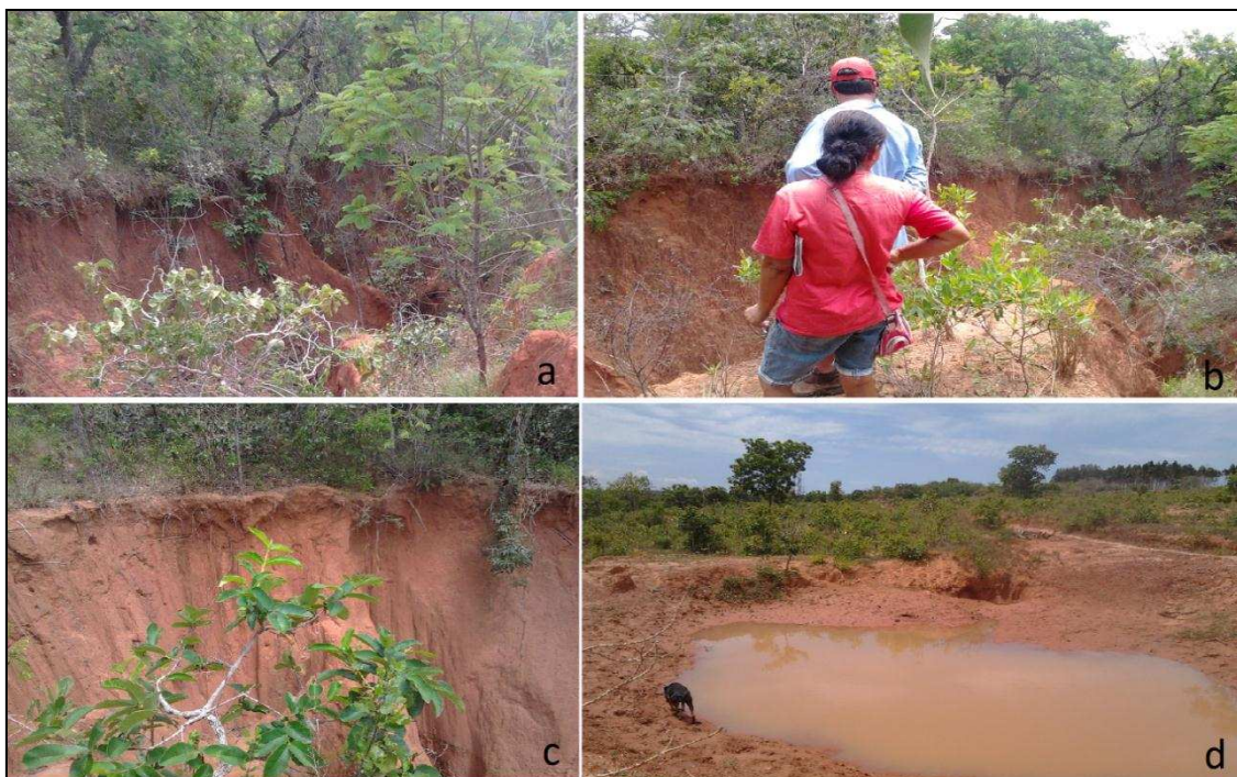
Figura 25. Imagens a, b e c referentes ao processo erosivo lote 7. Imagem d: Bolsão de contenção das águas pluviais lote 7. PA Flávia Nunes, Uberlândia - MG.
