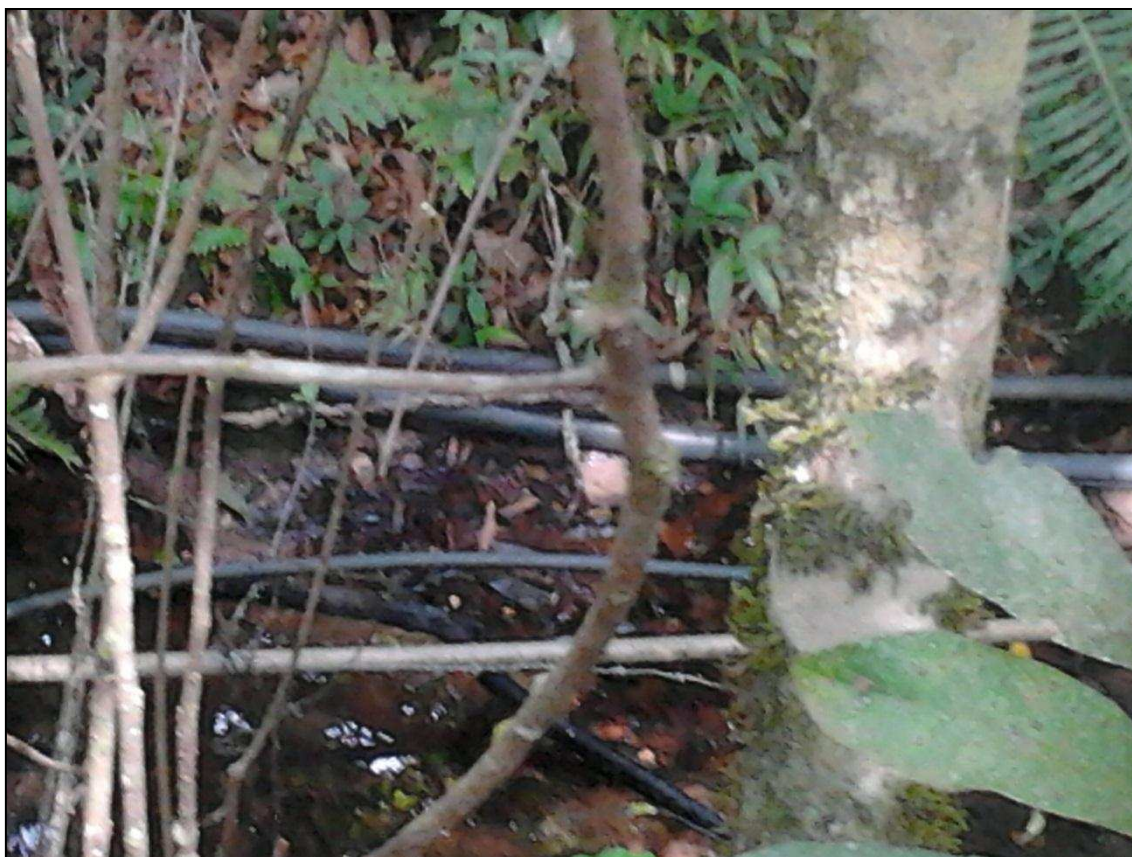
Figura 20. Foto da sobreposição de mangueiras para captação de água no PA Emiliano Zapata, Uberlândia-MG.
