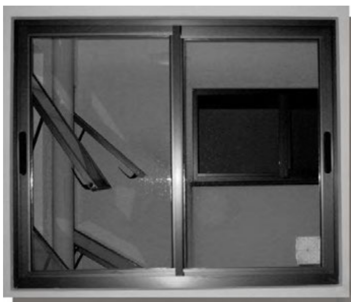
Figura 36: Janelas da unidade habitacional ED4.6.4 instalada em poço de ventilação e iluminação subdimensionado.
