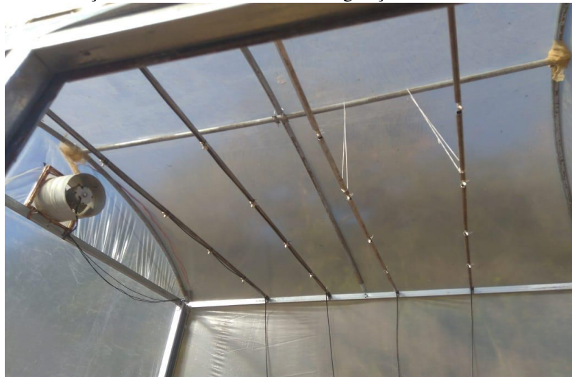
Figura 4 - Sistema de nebulização fixo instalado na casa de vegetação
