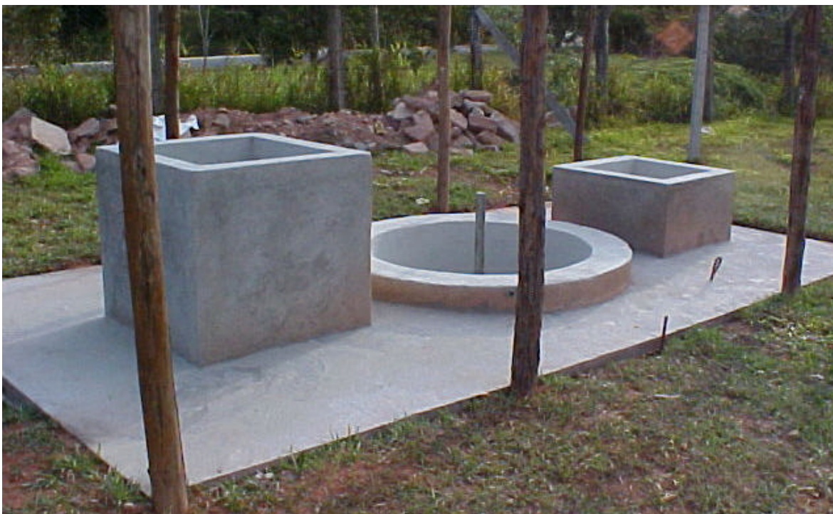
Figura 4. Vista externa do biodigestor modelo Indiano, caixa de carga e caixa descarga, componentes do sistema de biodigestão anaeróbia utilizado no experimento.
