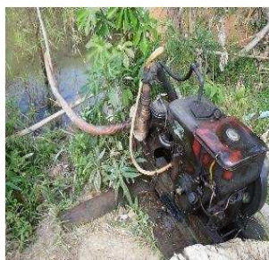
Figura 4 - Motor bomba conectado à represa no quintal Q_{Ja} Data: 12/06/2013
