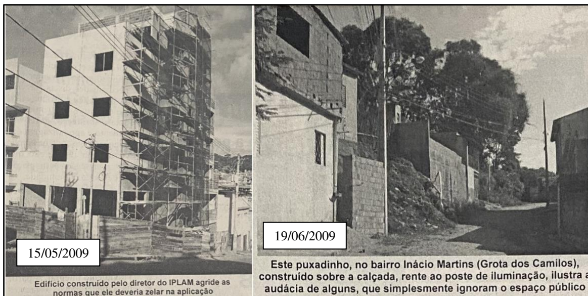
Figura 21 – Duas das obras irregulares realizadas em 2009, que apresentam muitas diferenças entre si
