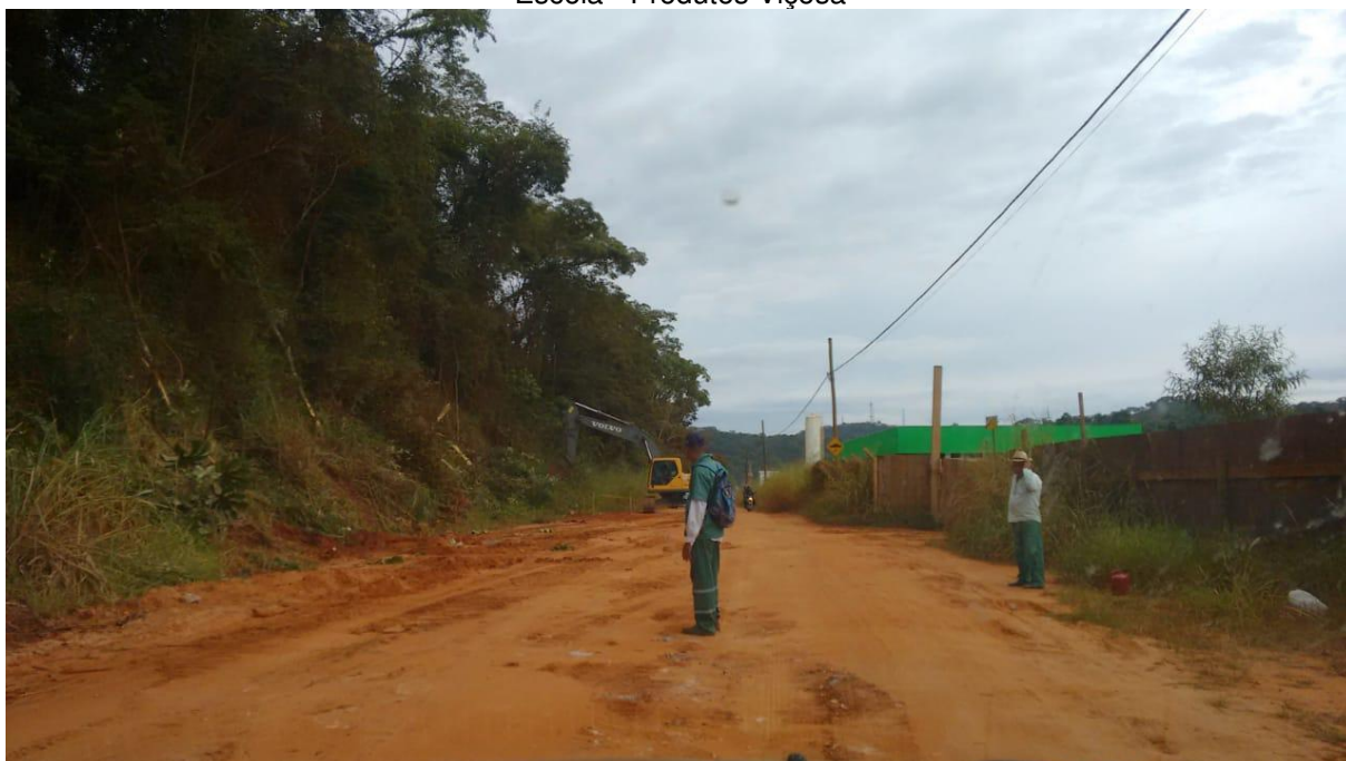
Figura 6 – Obra de alargamento da Estrada dos Cristais, ao fundo é possível visualizar o Laticínio Escola - Produtos Viçosa
