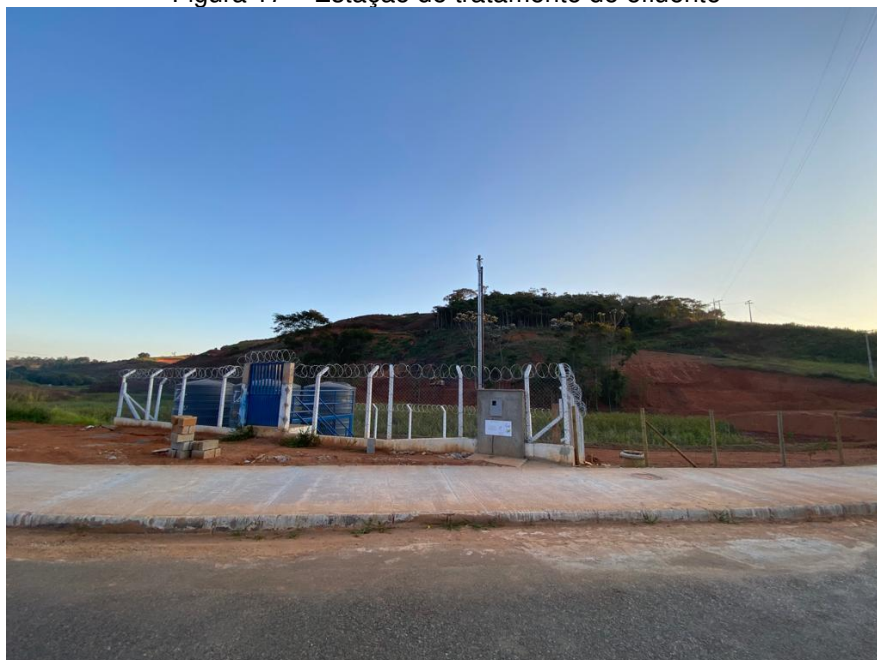
Figura 17 – Estação de tratamento de efluente
