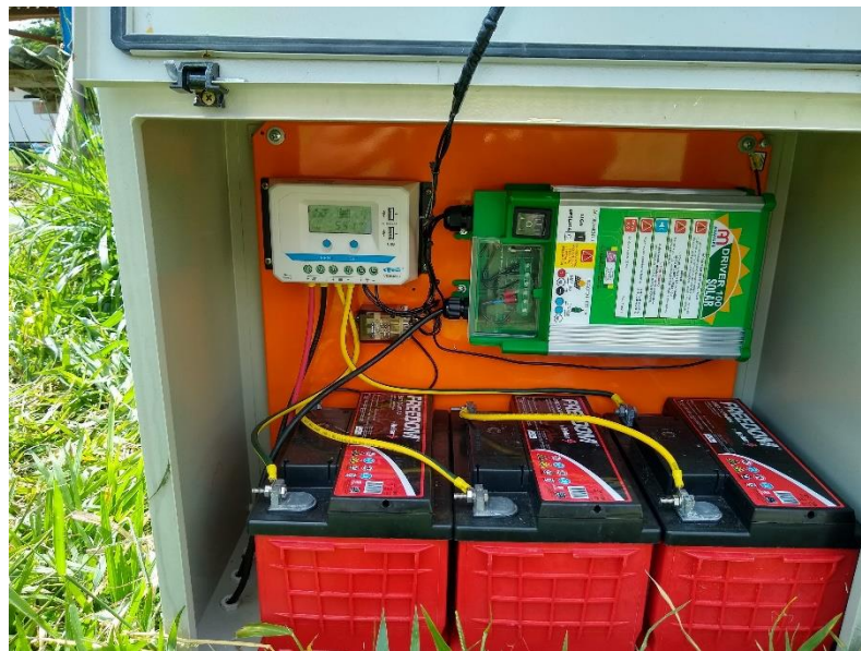
Figura 2.1.2. Sistema com baterias para armazenar energia (CB).
