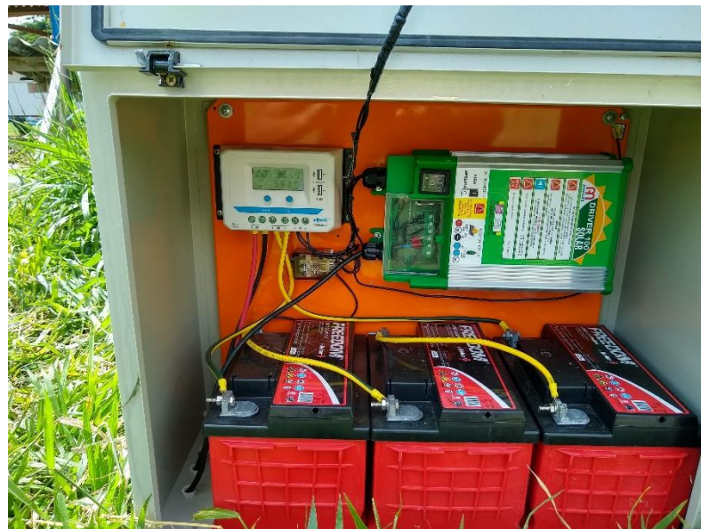
Figura 2.2.2. Sistema com baterias para armazenar energia (CB).
