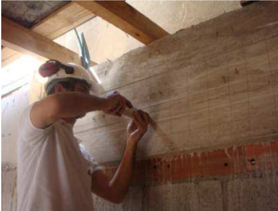
Figura 69 - Execução do ensaio de esclerometria sobre a superfície de uma viga de concreto armado em obra.
