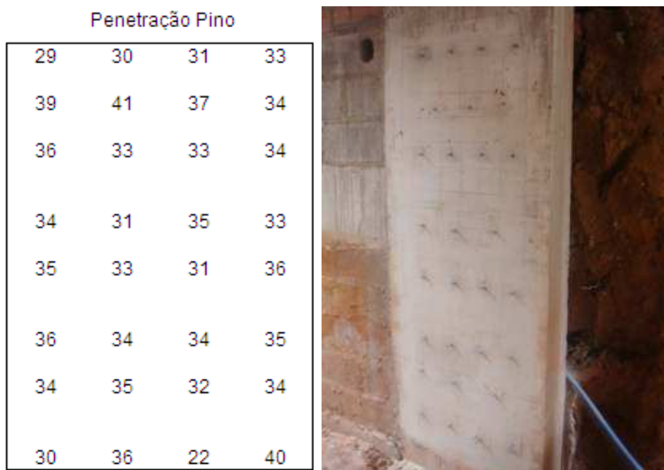
Figura 72- Resultados de ensaio de penetração de pinos na superfície de um pilar de concreto armado e vista geral do elemento ensaiado em obra.
