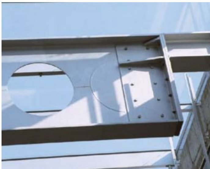
Figura 2.8 – Detalhe do fechamento de metade de um alvéolo em região de carga concentrada (ARCELORMITTAL, 2012).
