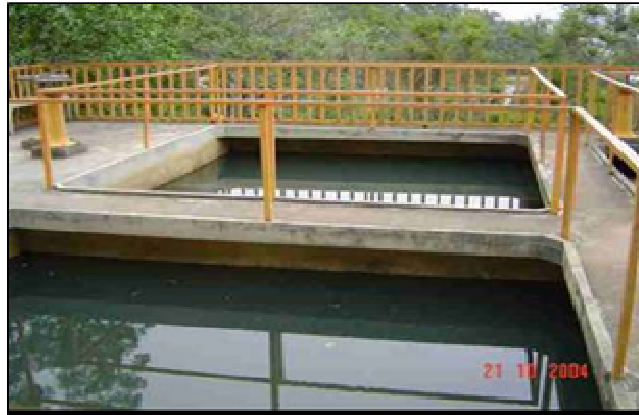
Figura 4.3: Vista dos filtros da ETA UFV
