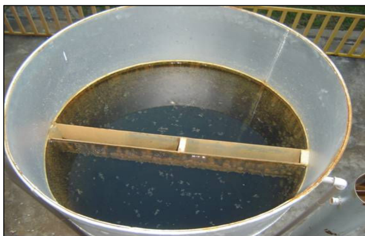
Figura 5.9: Vista superior do decantador da ETA piloto.
