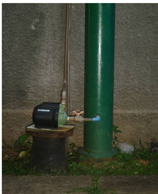
Figura 5.4: Detalhe da tomada de água bruta para alimentação da ETA piloto.
