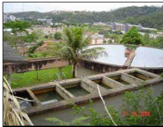
Figura 4.2: Vista do floculador e do decantador da ETA UFV.
