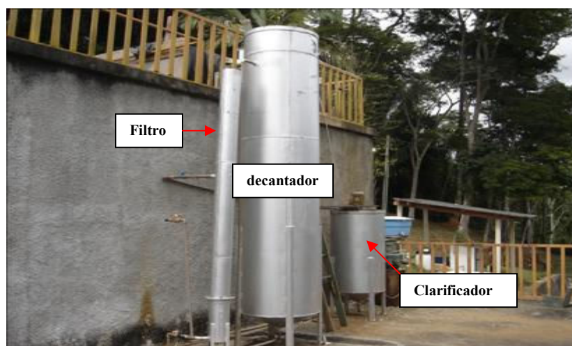
Figura 5.5: Vista parcial da ETA piloto.
