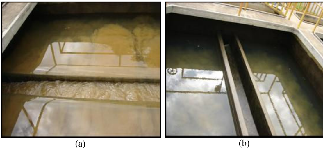
Figura 4.4: Início (a) e fim (b) da operação de lavagem dos filtros da ETA UFV.
