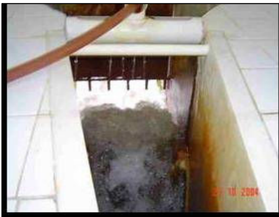
Figura 4.1: Detalhe da calha Parshall da ETA UFV.
