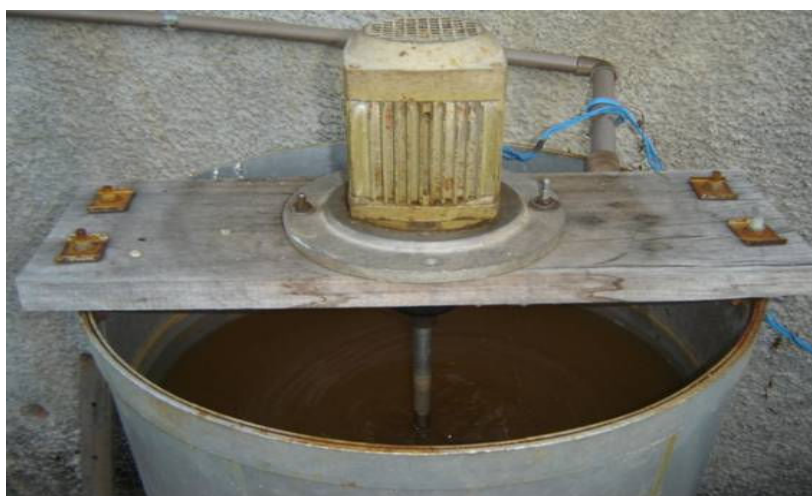
Figura 5.10: Detalhe do clarificador da água de lavagem de filtros da ETA piloto.
